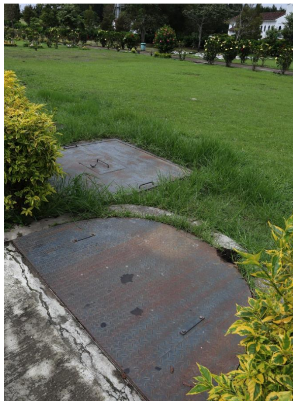
Ilustración 7. Pozos sépticos por fuera del laboratorio.
