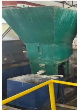
Ilustración 8. Maquina Dosificadora de Cal - Fuente propia.
