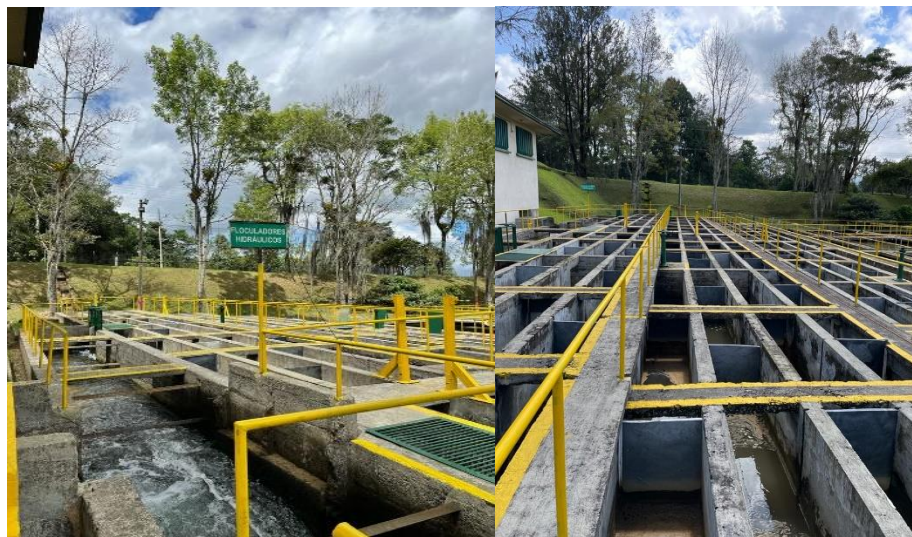
Ilustración 10. Floculadores Hídricos – Fuente propia.
