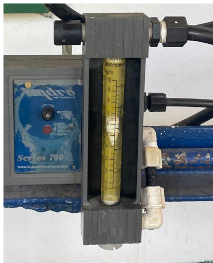
Ilustración 31. Rotámetro dosificador de cloro - Fuente propia.
