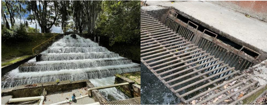
Ilustración 5. Cascada y rejilla de control de basuras – Fuente propia.
