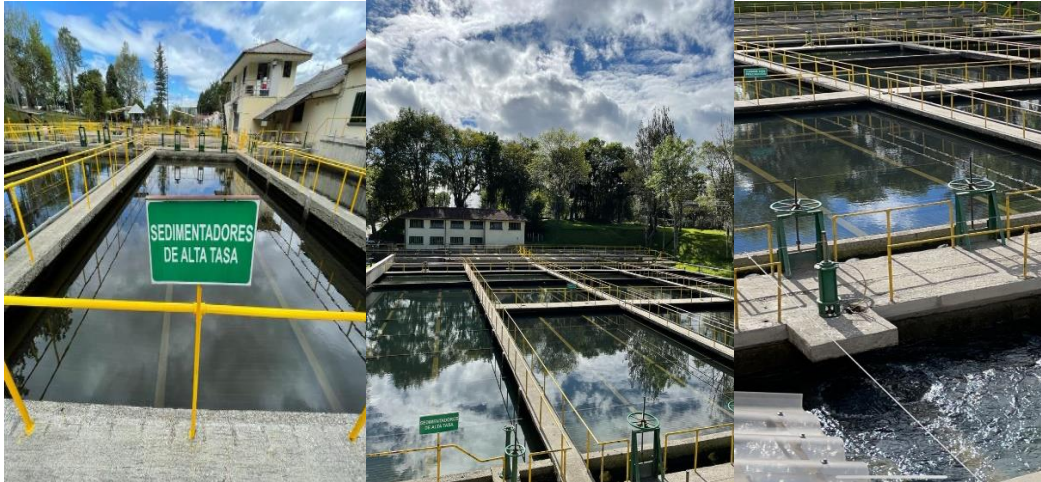
Ilustración 11. Sedimentadores - Fuente propia.
