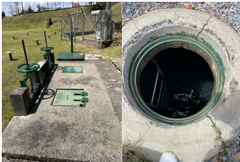
Ilustración 16. Entrada Tanques de Almacenamiento - Fuente propia.
