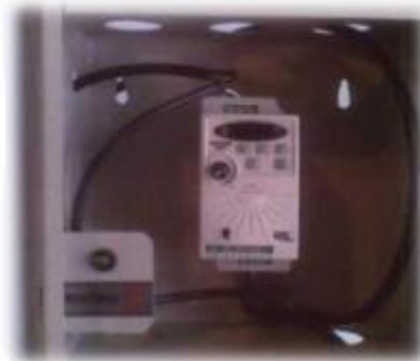
Ilustración 29. Variador de velocidad maquina Dosificadora – Fuente fadipartes.com.
