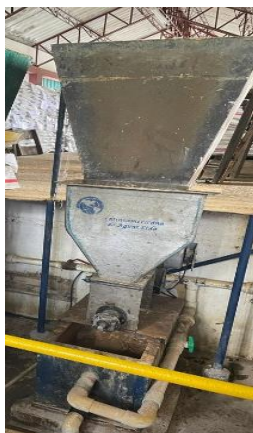
Ilustración 26. Dosificadora de Sulfato - Fuente propia.
