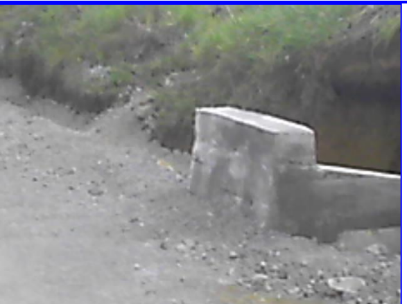
Foto No 20. Caja de salida.
