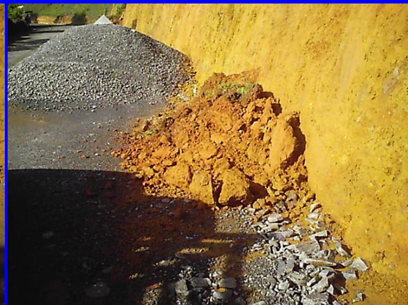
Foto No 28. Contaminación del material de afirmado debido al pequeño derrumbe.
