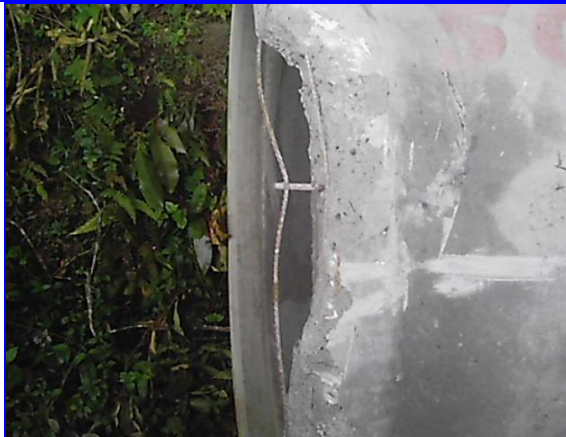
Foto No 25. Daños en la campana de la tubería debido al transporte.
