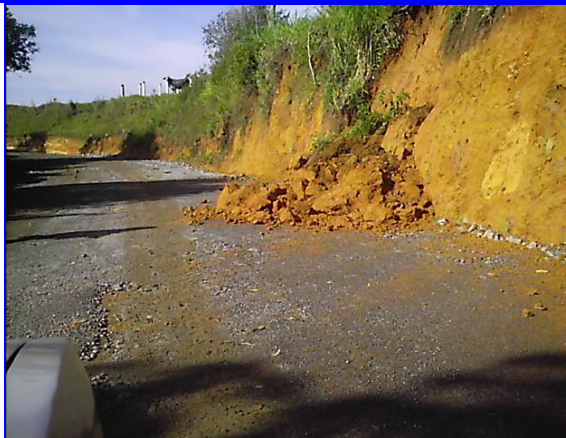
Foto No 27. Derrumbe del talud.
