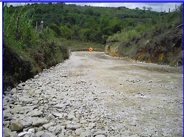
Foto No 24. Capa terminada de sub-rasante. (Se observan los sobretamaños en las orillas para mayor drenaje).
