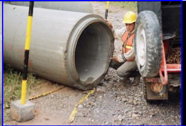
Foto No 26. Daños en la campana de la tubería en el descargue.
