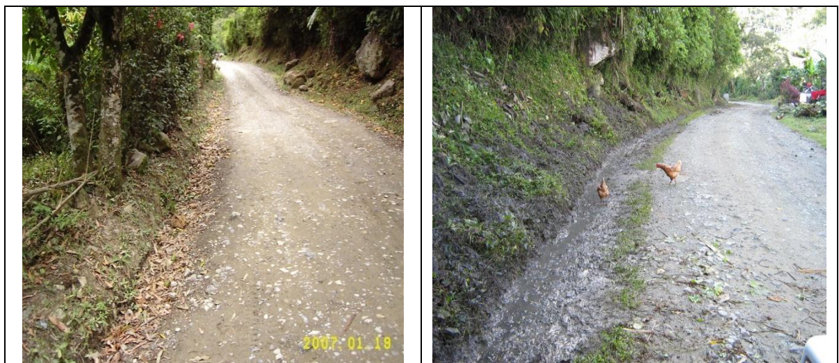
Figura 16. Trabajo rutinario – Cunetas sucias
