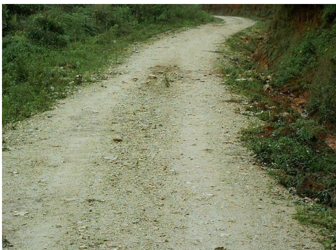
Figura 13. Trabajo rutinario – vía sin mantenimiento
