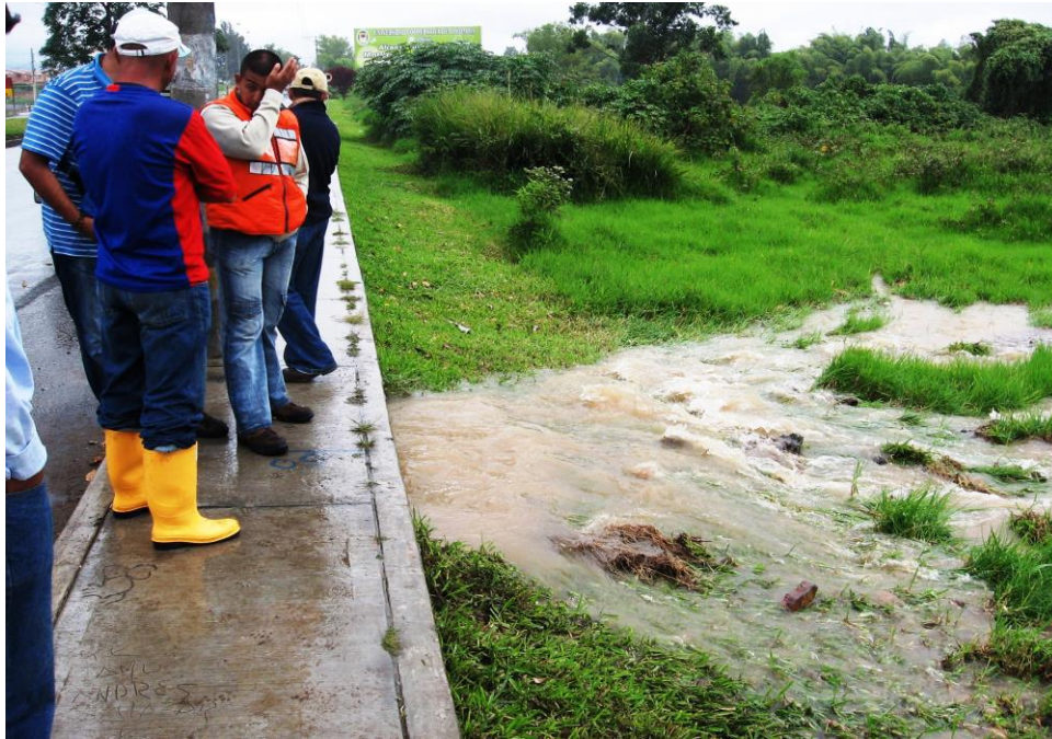
FIGURA 6.17 DIMENSIONES DEL DAÑO LÍNEA DE Ø 16" SOBRE LA CRA. 9ª, A LA ALTURA DE TORREMOLINOS
