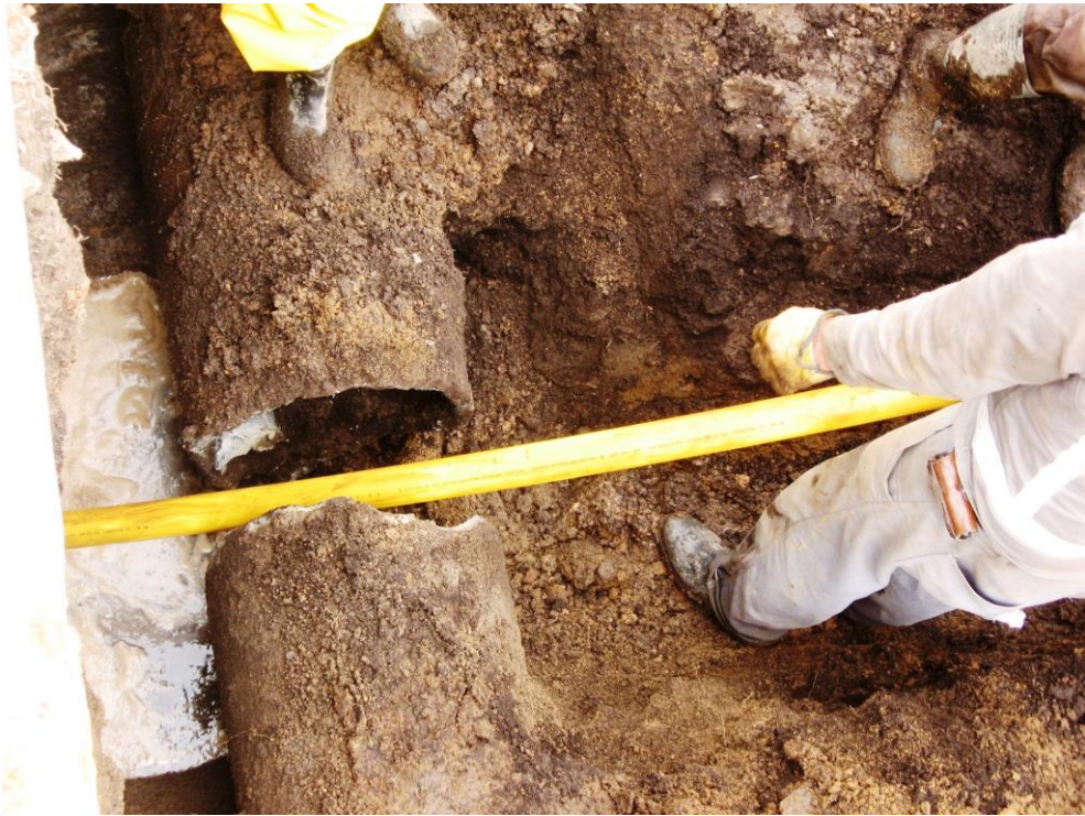
FIGURA 6.19 TUBERÍA PARA LA CONDUCCIÓN DE GAS ATRAVESANDO LA RED
