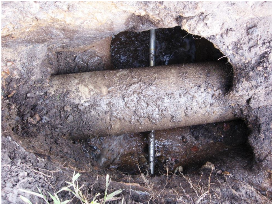
FIGURA 6.18 TUBERÍA TOTALMENTE PERFORADA POR CONTRATISTAS
