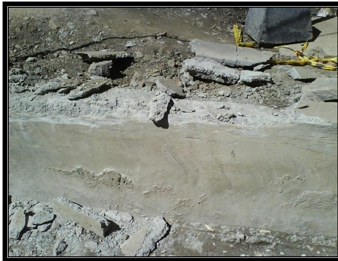
FOTO No 12, DESCASCAMIENTO DE SARDINELES (PR 66+0115)
