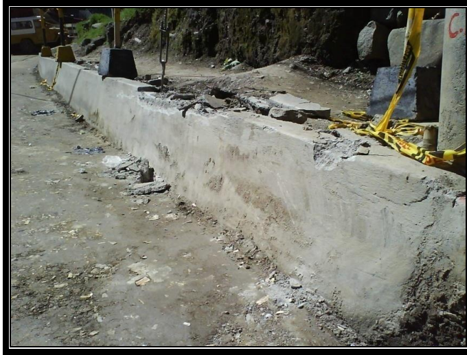
FOTO No 11, DEFICIENCIAS EN LOS ACABADOS DE LOS SARDINELES (PR 66+0106)
