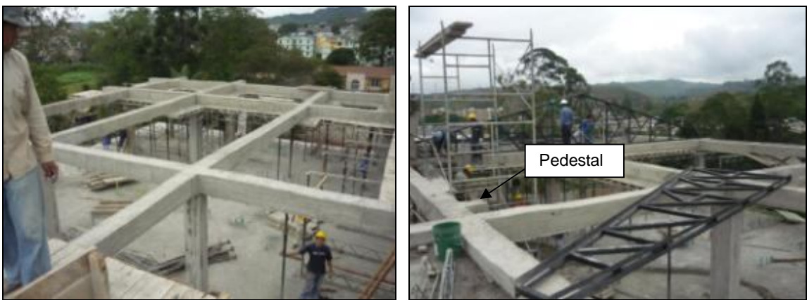
Figuras 65 y 66. Vigas que soportan la cercha e instalación de la cercha
