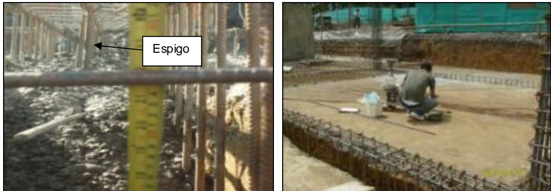
Figuras 5 y 6. Medición de profundidad y Vigas con superficies sin fundir.
