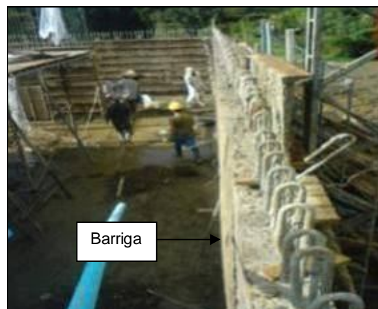
Figura 31. Deformaciones en el muro
