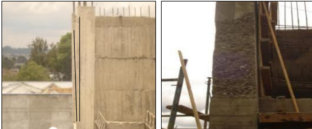
Figuras 46 y 47. Pérdida de verticalidad del muro y corrección del mismo
