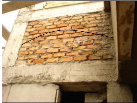
Figuras 81. Muro con deformación en su plano
