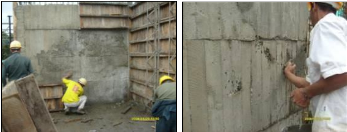
Figuras 32 y 33. Hormigueros y sellados de los mismos
