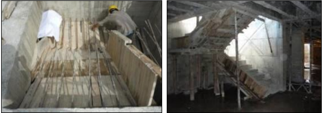
Figuras 58 y 59. Encofrado para la base de las escaleras y armado del refuerzo
