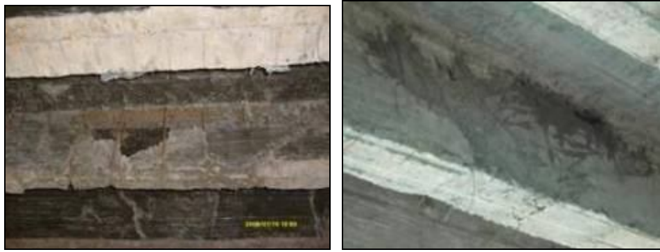
Figuras 56 y 57. Viguetas con refuerzo expuesto y corrección de las mismas
