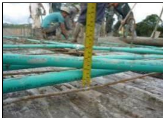
Figura 55. Verificación en la altura de la instalación de las tuberías para cableado eléctrico
