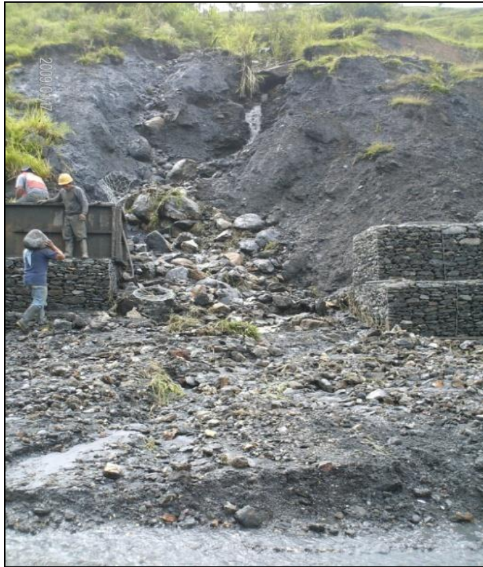
Foto 1. Deslizamiento en el PR 91+0600
