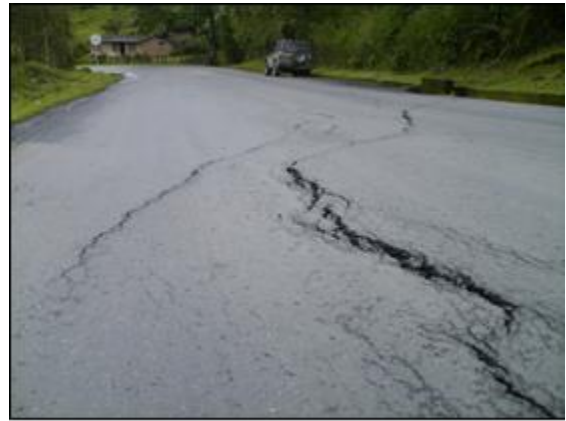
Foto 3. Asentamiento de la calzada PR 88+0500
