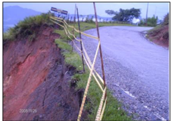
Foto 4. PR 74+0600, Falla del talud inferior que avanza peligrosamente hacia la calzada
