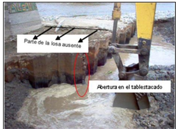
Foto 18. Falta parte de la losa- Pila Norte, puente DOS RIOS
