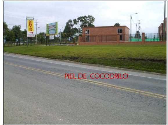
Foto 12. Piel de cocodrilo PR 12+0300, Conjunto cerrado Entrepinos. Variante Norte.
