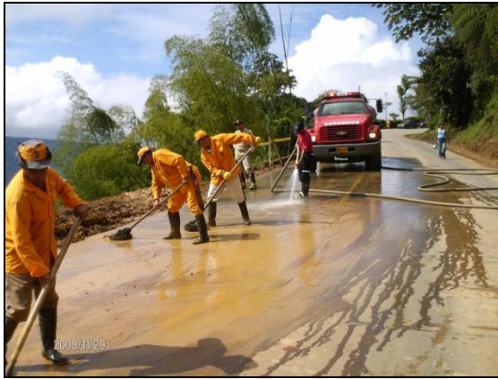
Foto 25. Labores de limpieza de la calzada tras la emergencia en el PR 114+0900
