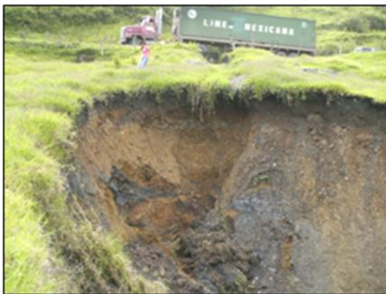
Foto 5. PR 91+0300. Socavación por acción del agua que evacua la alcantarilla.
