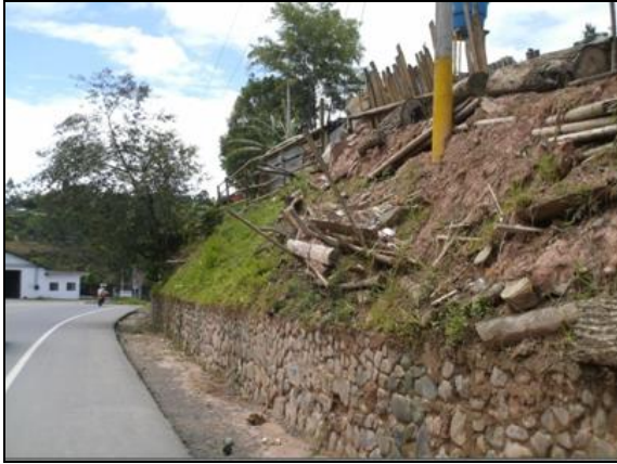
Foto 33. Invasión a la zona de Derecho de Vía. PR 120+0600
