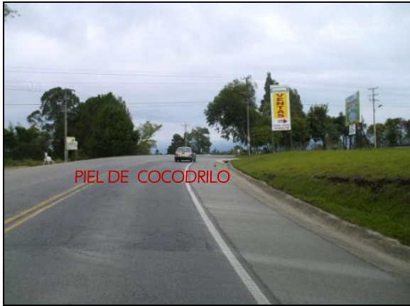
Foto 11. Piel de cocodrilo frente al Conjunto Cerrado Entrepinos, PR 12+0300,
