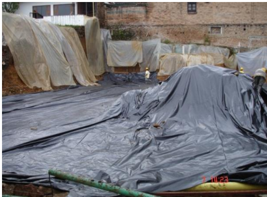
Plástico negro para protección del terreno
