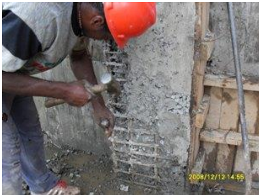
Hormigueros profundos en columna.
