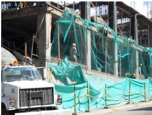
Malla de protección.
