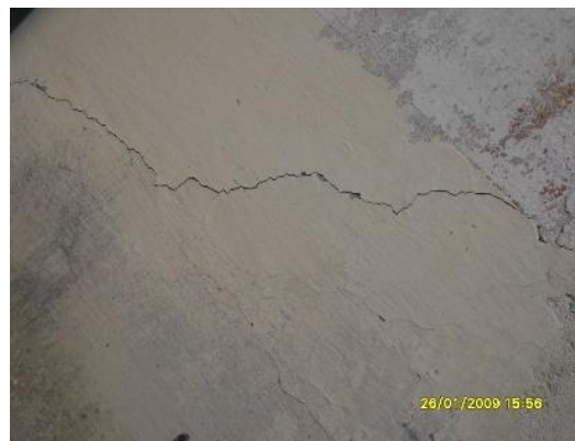
Grietas muro patio casa vecina.
