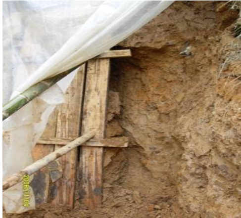
Falla del talud costado sur.
