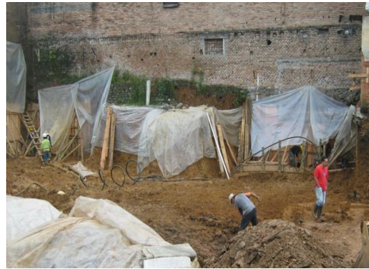
Evacuando aguas negras de casa vecina.
