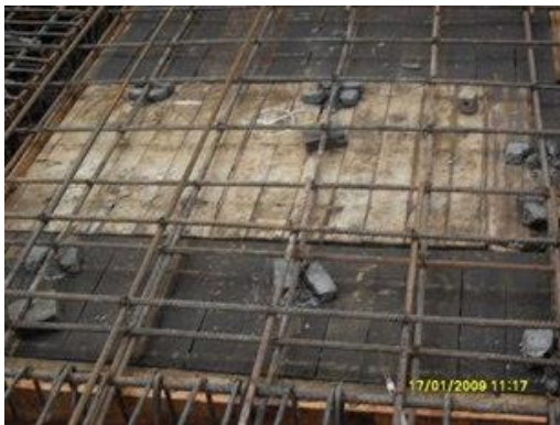
Falla de paneles para recubrimiento.
