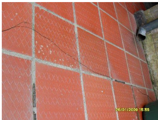
Grietas piso del patio casa vecina.
