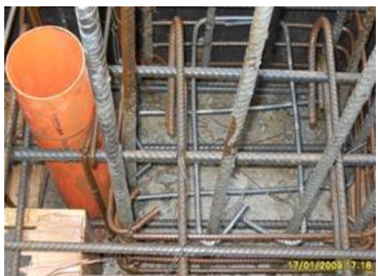
Pases para bajante agua lluvia.
