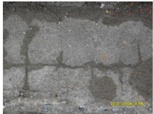
Fisuras por falta de recubrimiento.
