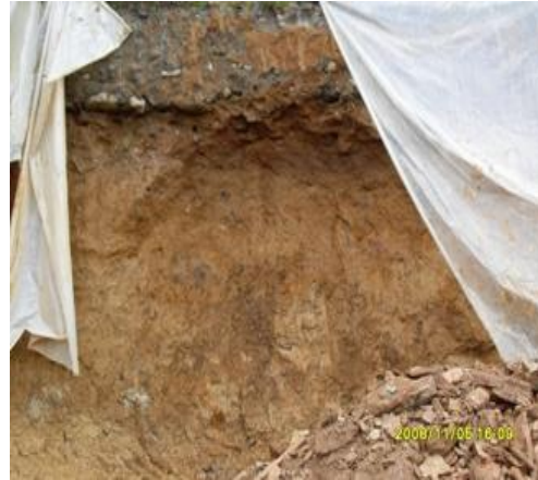
Falla del talud costado sur.
