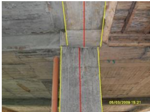
Ejes desalineados columna D-9 nivel +6.30.
