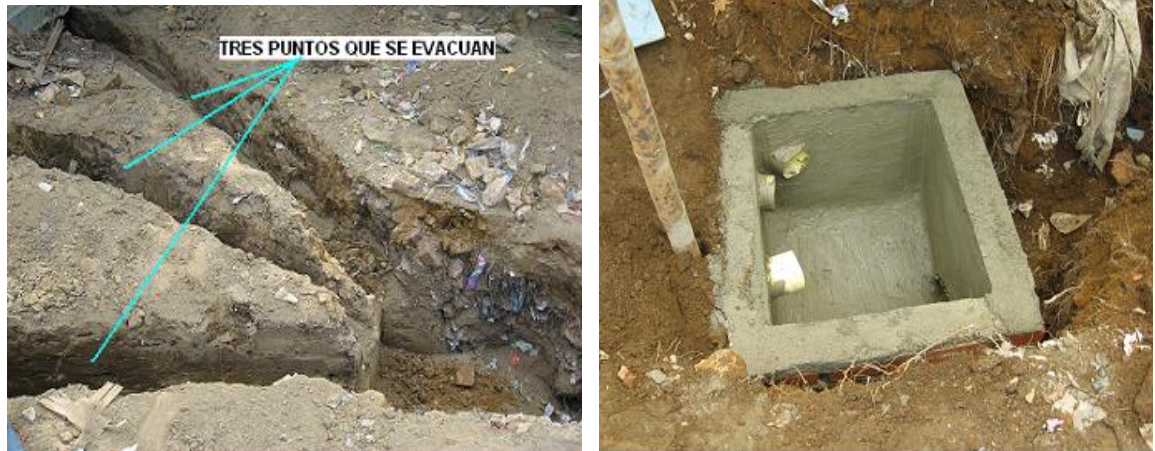
Fotos 1,2. Caja de inspección.
