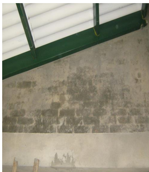
Foto 8. Inadecuado curado del repello.
