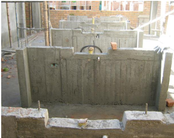
Foto 3. Mesones en concreto
