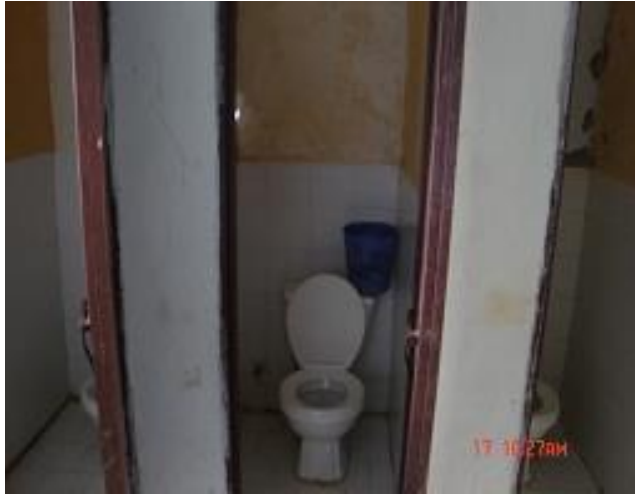
Fotos 1,2, Batería sanitaria en mal estado
