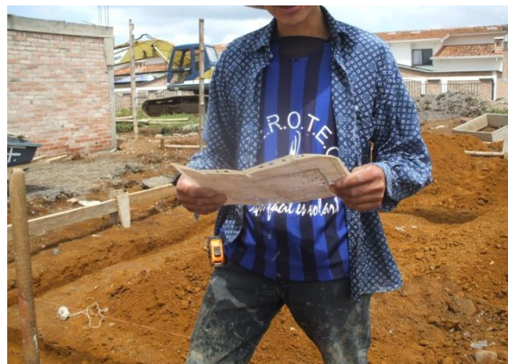
FOTO N°21: LECTURA DE PLANOS PARA COLOCAR LOS HILOS GUIA PARA ZANJAS DE CIMENTACION
