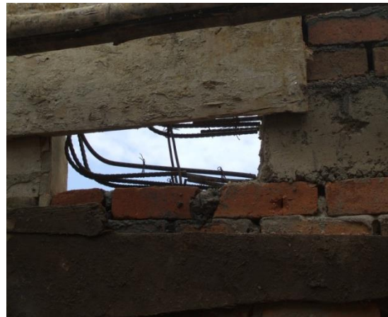
FOTO N°136: TRANSLAPO DEL ARCO DE ACERO Y EL ACERO DE LA VIGA DE CUBIERTA
