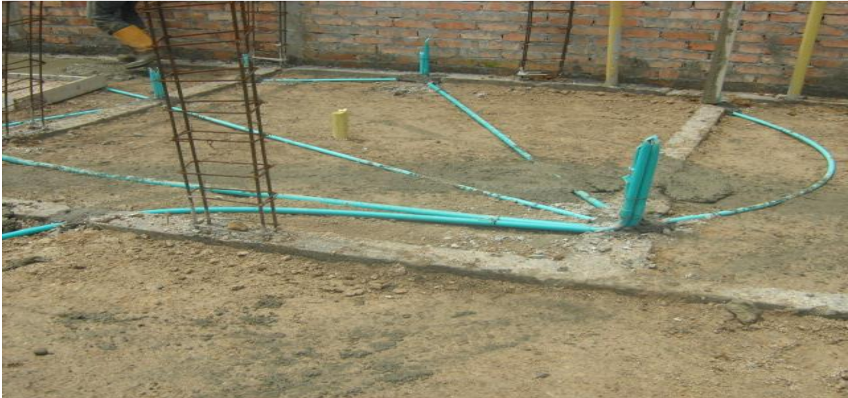
FOTO N°28: INSTALACIONES ELECTRICAS DEL PRIMER PISO
