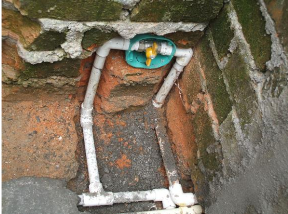
FOTO N°119: INSTALACION DE AGUA POTABLE (LLAVE DE PASO GENERAL)
