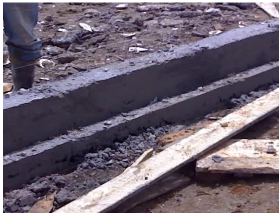
FOTO N°70: PROBLEMA DE HORMIGUEROS SOBRE LAS VIGAS DE CIMENTACION
