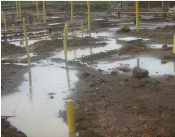
FOTO N°167: PROBLEMAS DE INUNDACION POR EL AGUA LLUVIAS SOBRE EL TERENO DE CONSTRUCCION
