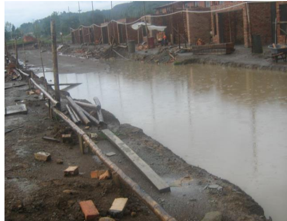
FOTO N°168: PROBLEMAS DE INUNDACION POR EL AGUA LLUVIAS SOBRE LA VIA DE ACCESO
