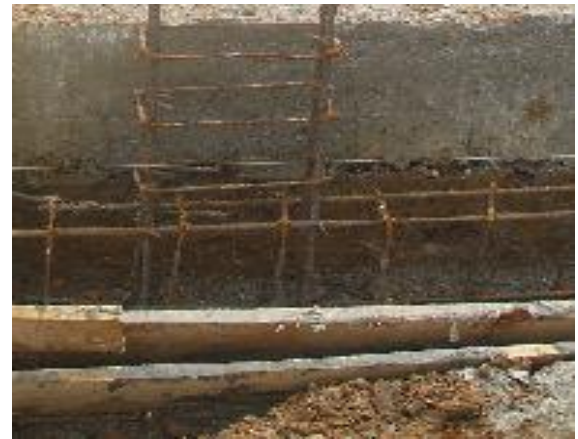
FOTO N°50: ARMADO Y COLOCACION DEL ACERO DE LAS COLUMNAS PARA EL PRIMER PISO
