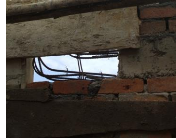
FOTO N°68: TRANSLAPO DEL ARCO DE ACERO Y EL ACERO DE LA VIGA DE CUBIERTA
