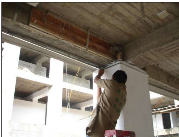
Colocación del cuadrante en el muro, para el cielo falso del primer piso
