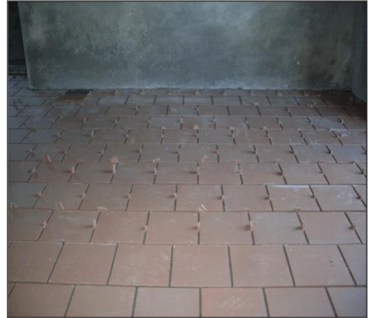
Losa de un salón del cuarto piso
