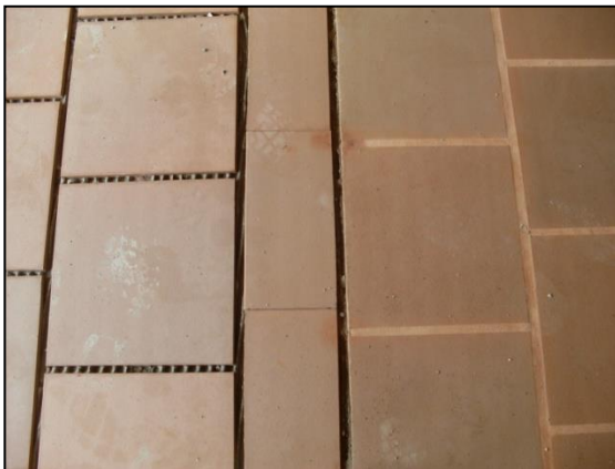
Piso sin fragua y el otro ya fraguado.
