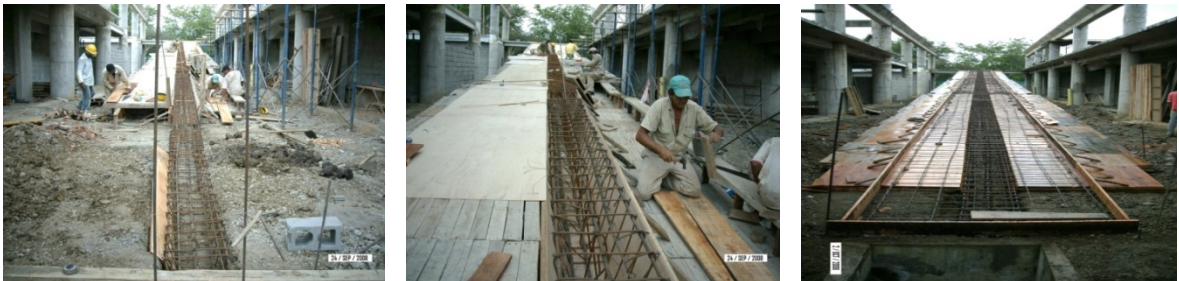
Construcción de rampa PMR ubicada entre los ejes O-P a lo largo de los ejes 25-31 (encofrado, amarre de acero, chequeo de dimensiones etc.)
