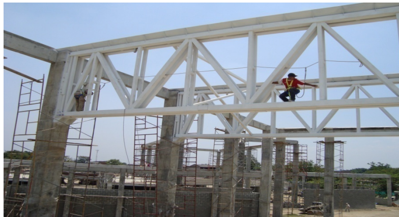
Línea de vida para trabajos en niveles mayores a 2.5m
