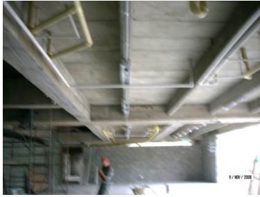
Tubería sanitaria e Hca.
