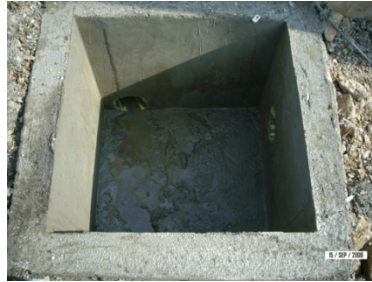
Caja aguas lluvias
