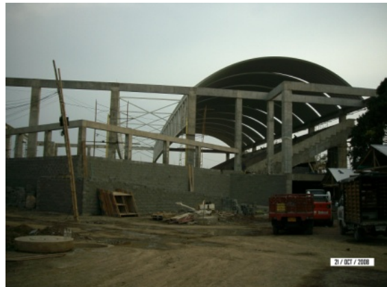
Se evidencia el problema de deflexión Htal.
