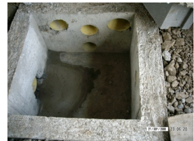
Caja aguas residuales
