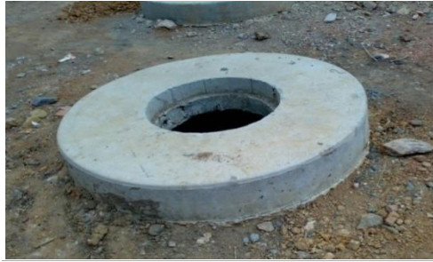
Figura 16. Cámara de inspección
