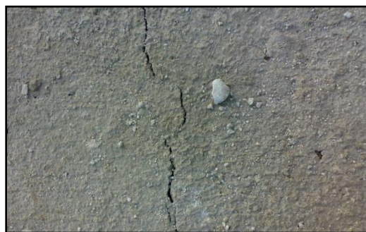
Figura 50. Fisura debida a un curado inadecuado
