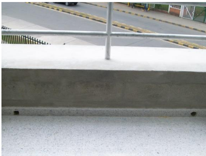
Ilustración 68, Perforaciones en la guardaescoba de las gárgolas.
