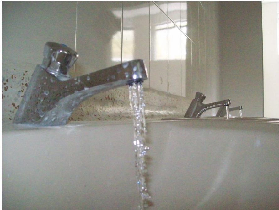
Ilustración 98, Grifos funcionando y calibrados a 8 segundos.
