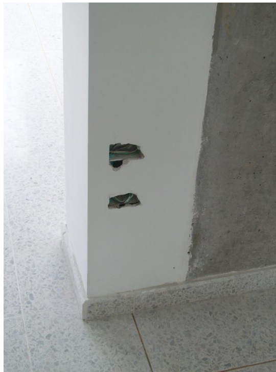
Ilustración 67, En esta imagen se puede ver el remate de las guardaescobas en las esquinas.
