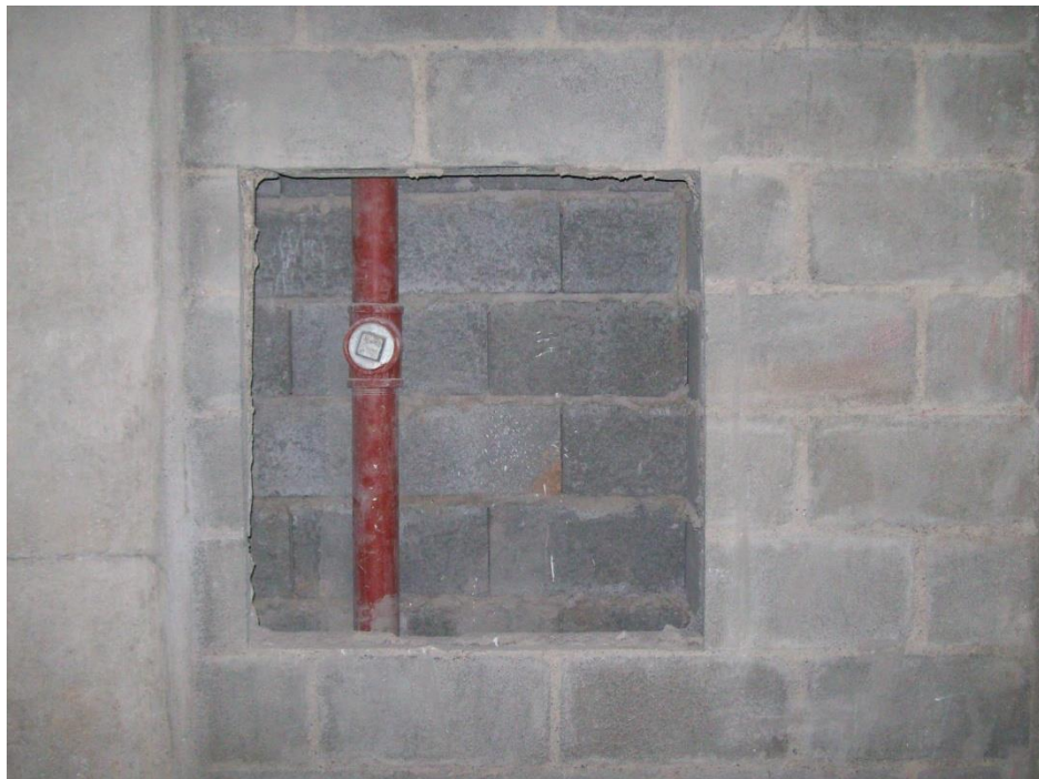
Ilustración 112, Espacio adecuado para el gabinete.
