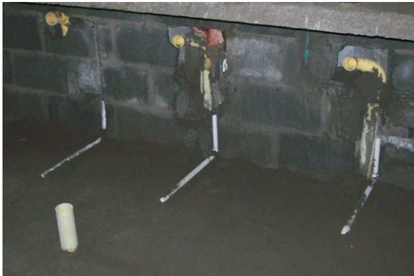
Ilustración 71, Algunos puntos hidráulicos ya instalados.
