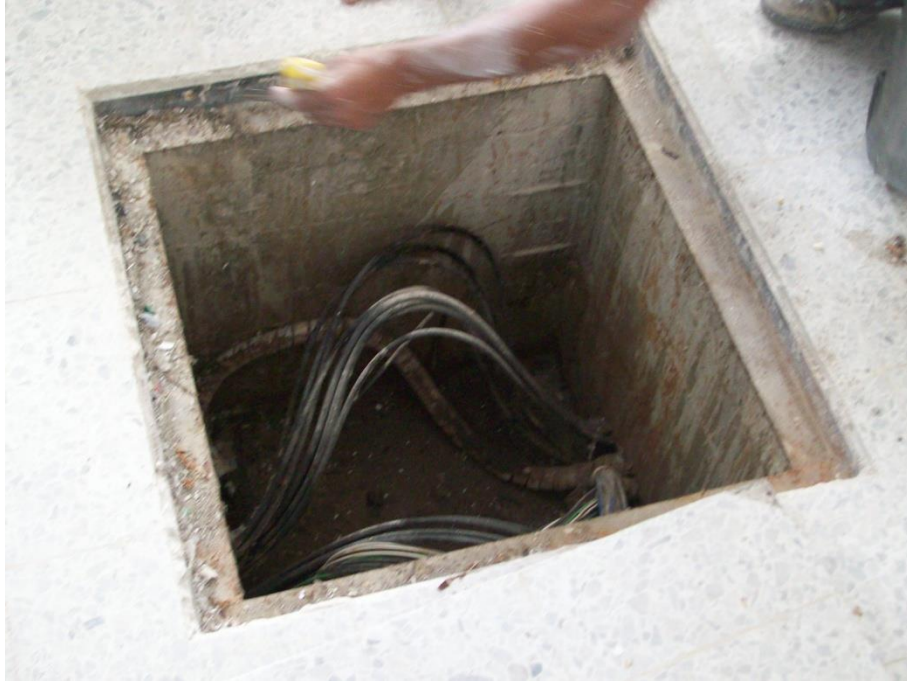
Ilustración 116, Caja de inspección de las redes eléctricas, nótese el marco metálico en proceso de instalación.
