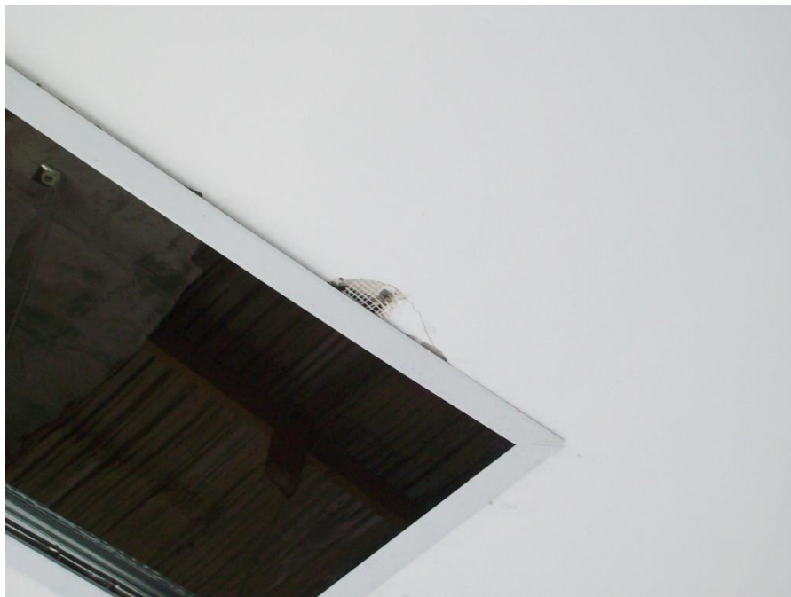
Ilustración 88, Defectos detectados después de la instalación de los marcos de las lámparas, estos fueron posteriormente reparados.
