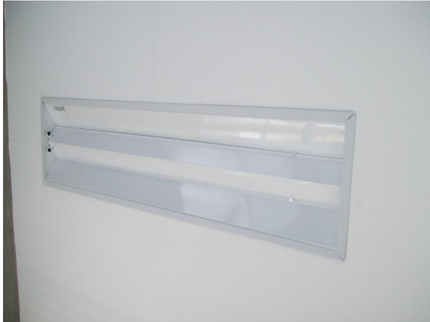
Ilustración 105, Lámpara fluorescente instalada.
