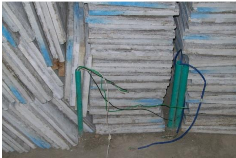
Ilustración 36, Posible problema generado por el arrume de las baldosas, se sugirió cambiar el sitio de almacenamiento para no afectar las instalaciones eléctricas.
