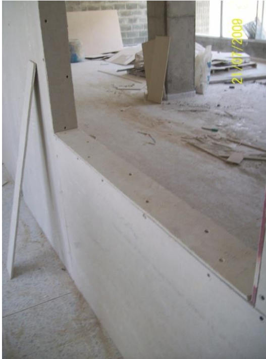
Ilustración 26, Detalle del atornillado de placas en las ventanas, nótese como están alternados los tornillos.
