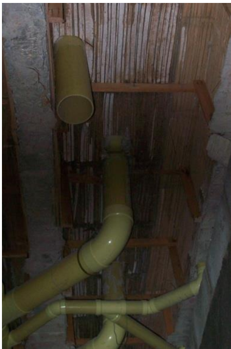
Ilustración 77, Red sanitaria vista por debajo del piso.
