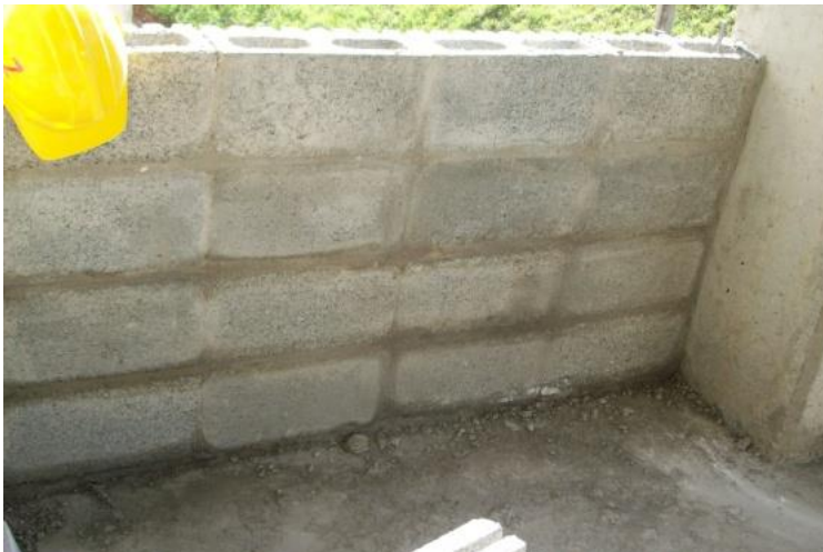
Ilustración 9, Muro en bloque acanalado por la parte de atrás, nótese la pega en forma "apanalada".
