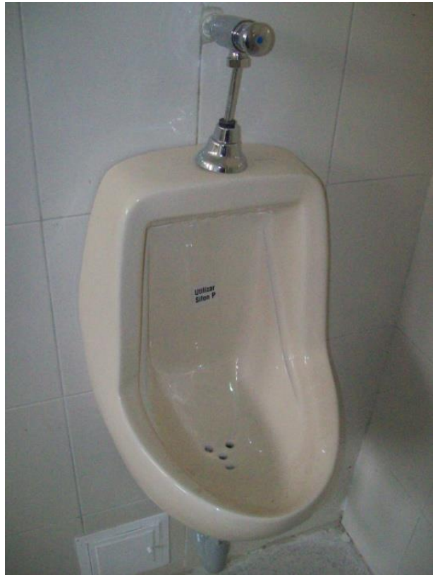
Ilustración 96, Orinales con sus accesorios en funcionamiento.
