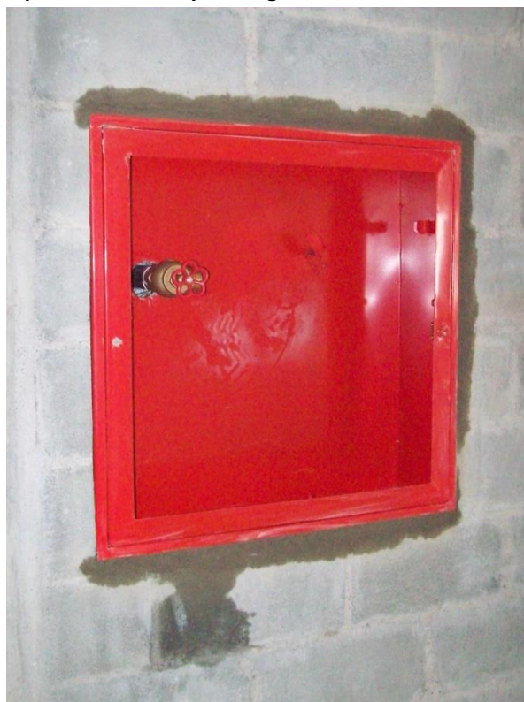
Ilustración 113, Gabinete ya instalado.
