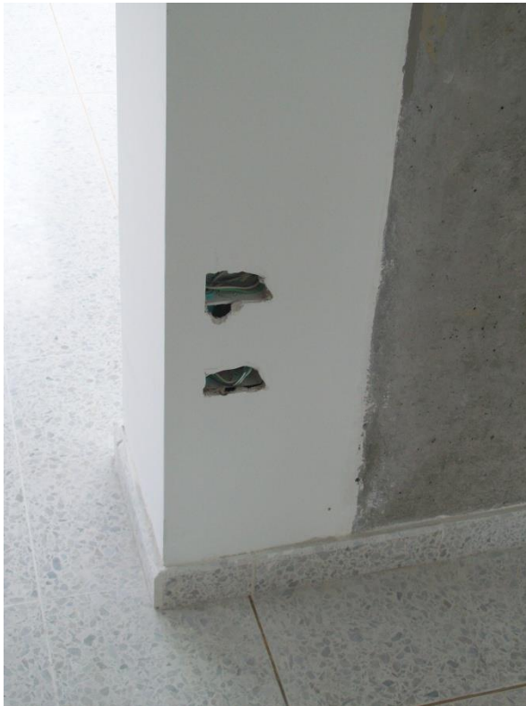
Ilustración 108, Agujeros dejados por los constructores para instalar tomas eléctricas.
