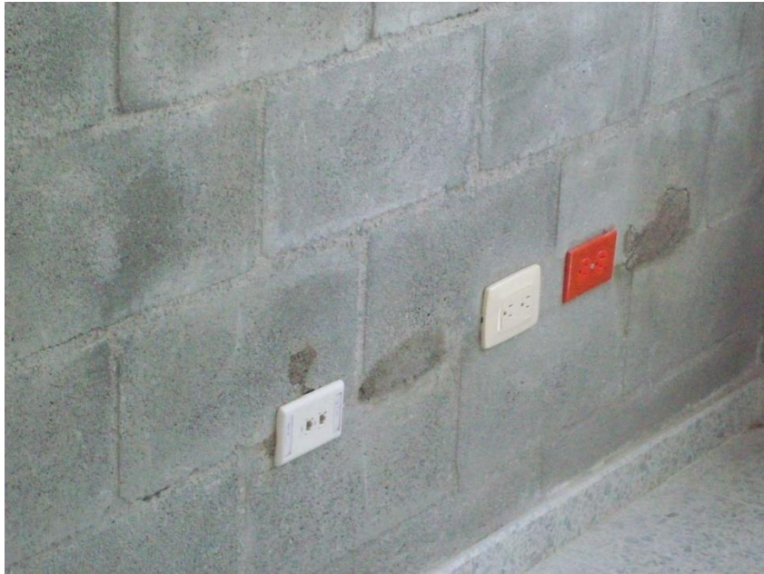
Ilustración 107, Algunos tomas instalados, se pueden apreciar algunos daños causados por su instalación.
