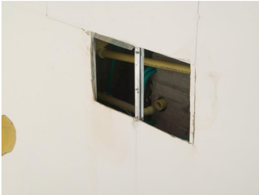
Ilustración 87, Algunas de las causa de daños en el cielo falso del primer piso, aquí se detalla una conexión sanitaria instalada erróneamente.
