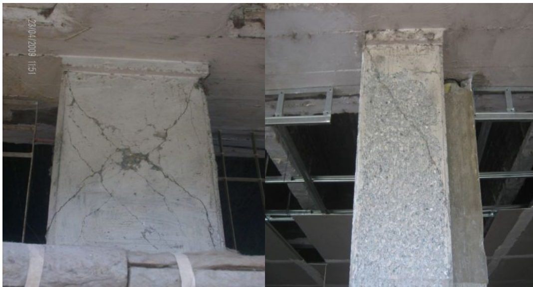
Fotografías 131 y 132 – Fallas por efecto de columna corta.
