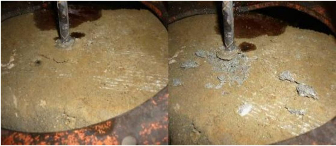
Fotografías 41 y 42 – Rotura del concreto por tracción directa.
