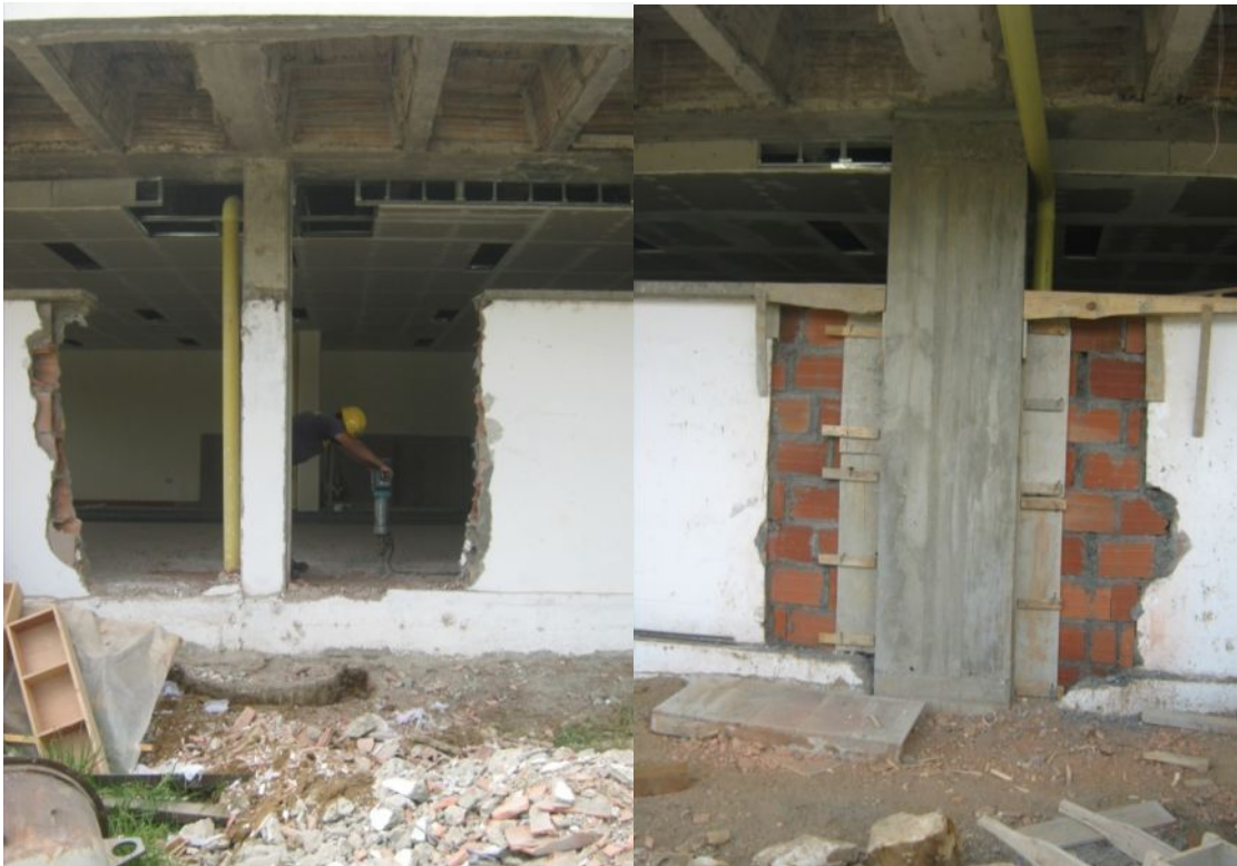
Fotografías 149 y 150 – Antes y después de columna encamisada sector 11.
