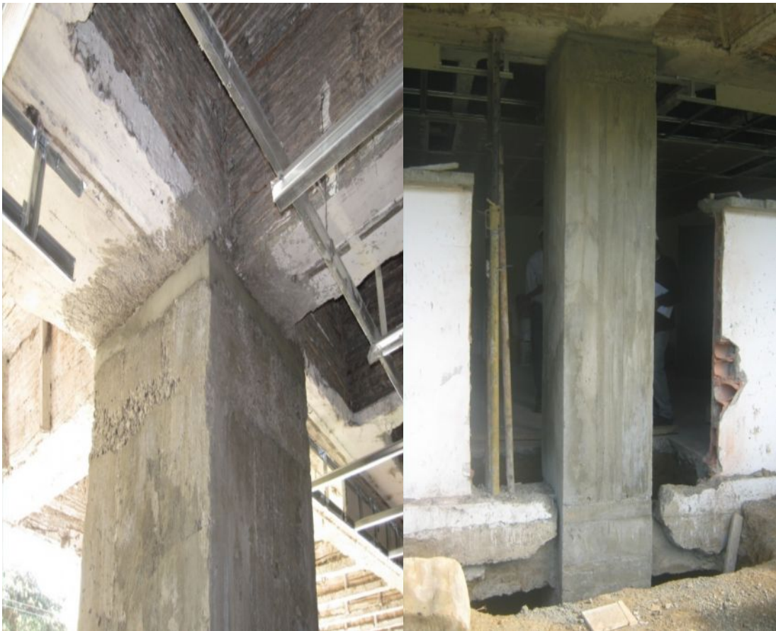
Fotografías 147 y 148 – Remate de columnas encamisadas con Dry Pack en el sector 11.
