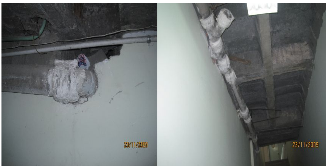
Fotografías 153 y 154 - Tuberías sanitarias en pésimo estado.
