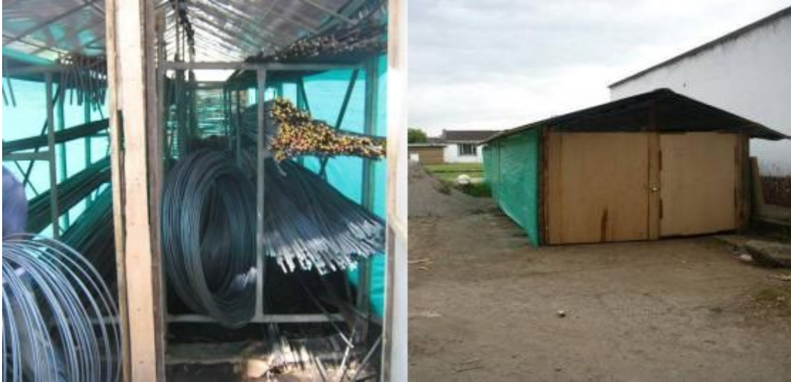
Fotografías 9 y 10 – Almacenamiento de acero.
