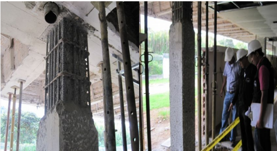
Fotografías 135 y 136 – Demolición de concreto hasta encontrar el núcleo de columnas del sector 11.
