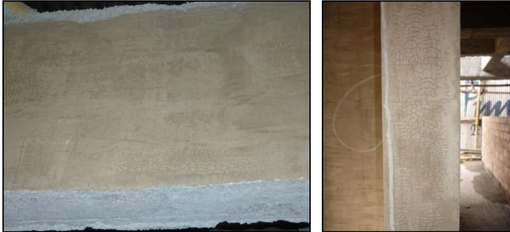
Ilustración 59. Fisuración de estuco
