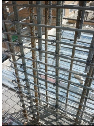
Ilustración 16. Varilla inadecuadamente traslapada
