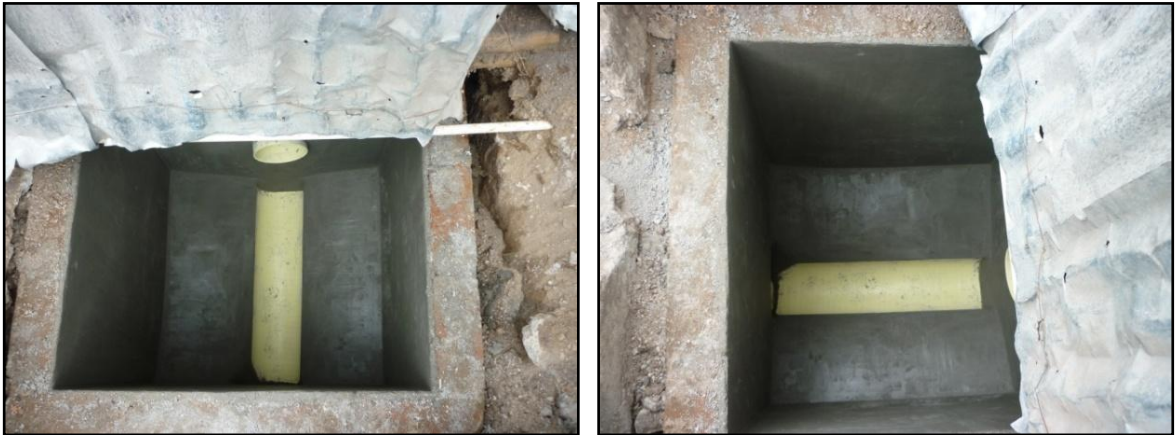
Ilustración 62. Cajas de inspección
