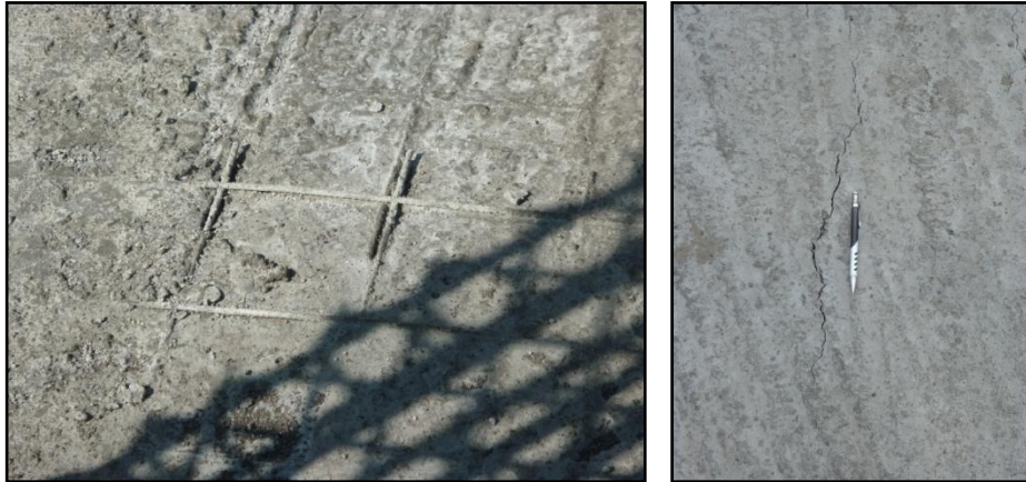
Ilustración 44. Fisuras en placa de entrespiso
