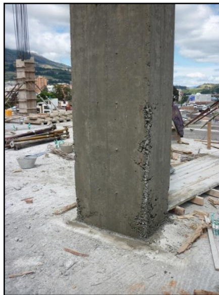
Ilustración 21. Hormigueros base columna
