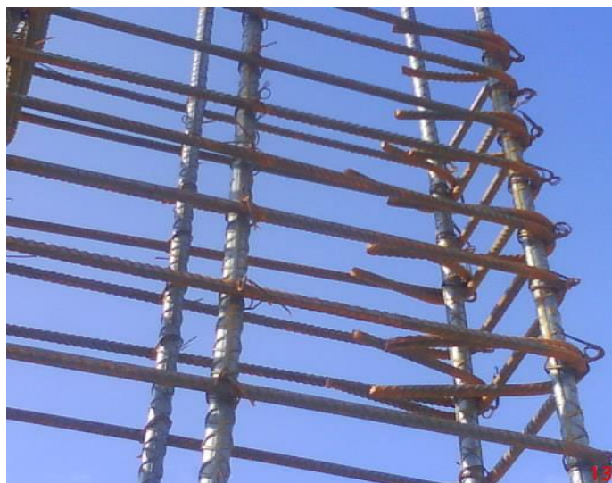
Ilustración 39. Ganchos de estribos en posición incorrecta en columnas
