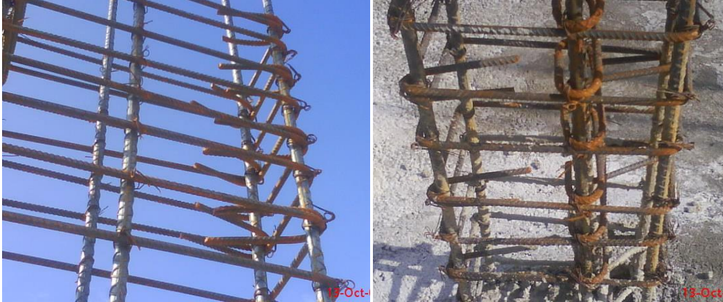
Ilustración 34. Ganchos de estribos y acero longitudinal en mala posición
