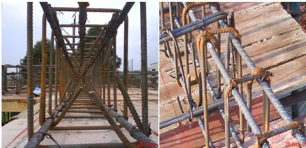
Ilustración 37. Ganchos de Estribos Incorrectos en Vigas
