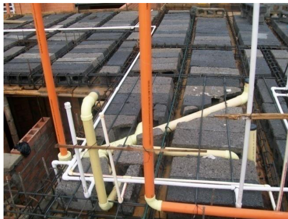
Foto 26. Tubería sanitaria (amarilla), aguas lluvias (anaranjada), y agua potable (blanca) instalada para el segundo piso casa estándar.
