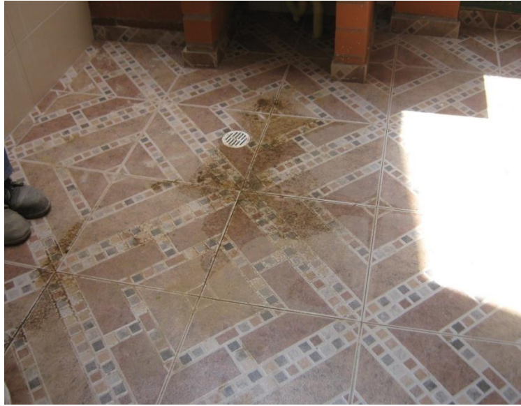
Foto 6. Mala colocación de fichas lo cual implica excedente en material
