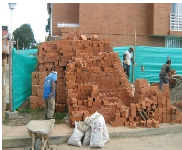
Foto 24. Almacenamiento indebido de las unidades de ladrillos
