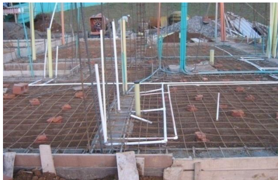
Foto 25. Tubería hidráulica instalada (primer piso) se distingue de las demás por ser de color blanca
