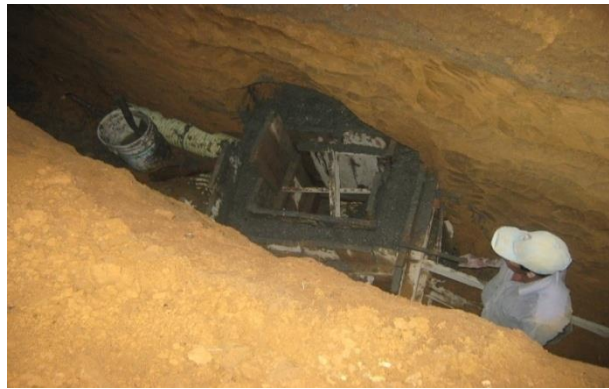
Foto 11. Construcción de una de las cámaras de inspección para la última etapa del conjunto.
