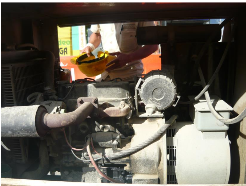
Figura 1. Mantenimiento preventivo en equipos.
