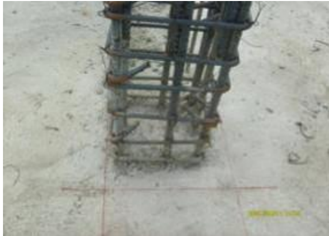
Figura N° 100. Pantalla de Muro fuera de su Eje.
