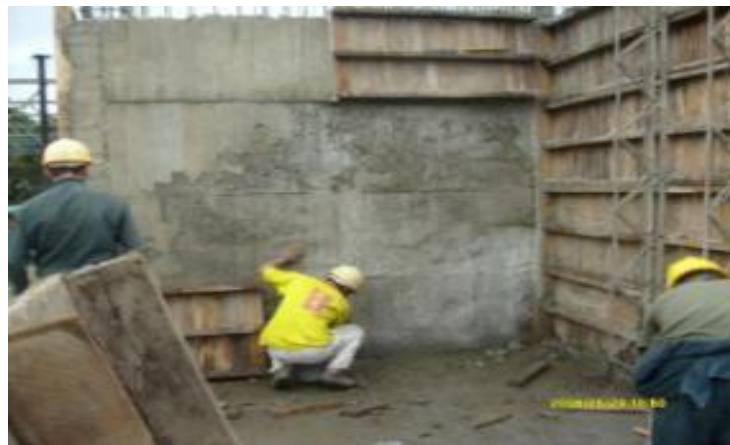
Figura N° 62. Deformaciones en el muro.
