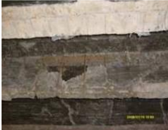
Figura N° 84. Zona de viguetas con el refuerzo expuesto.
