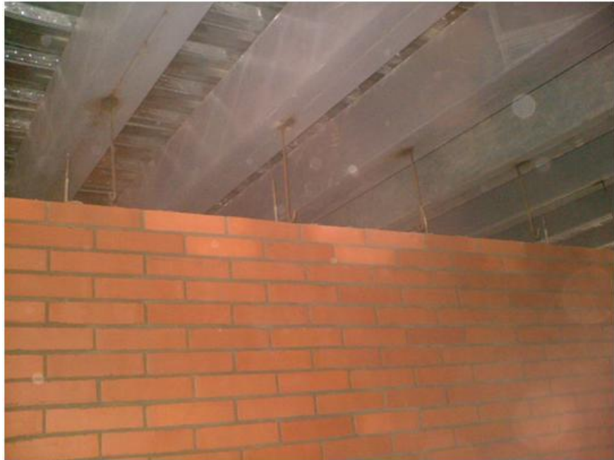
Figura 43. Acero de muro estructural soldado a viga metálica.
