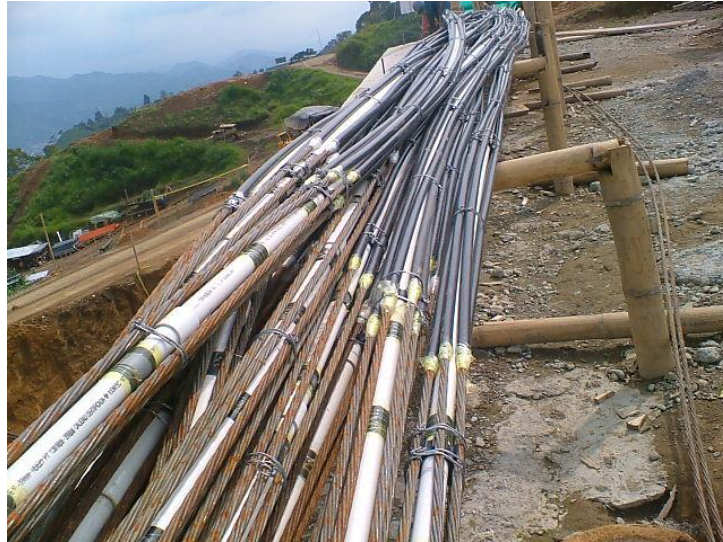
Figura 9. Manguera de protección para zona libre.
