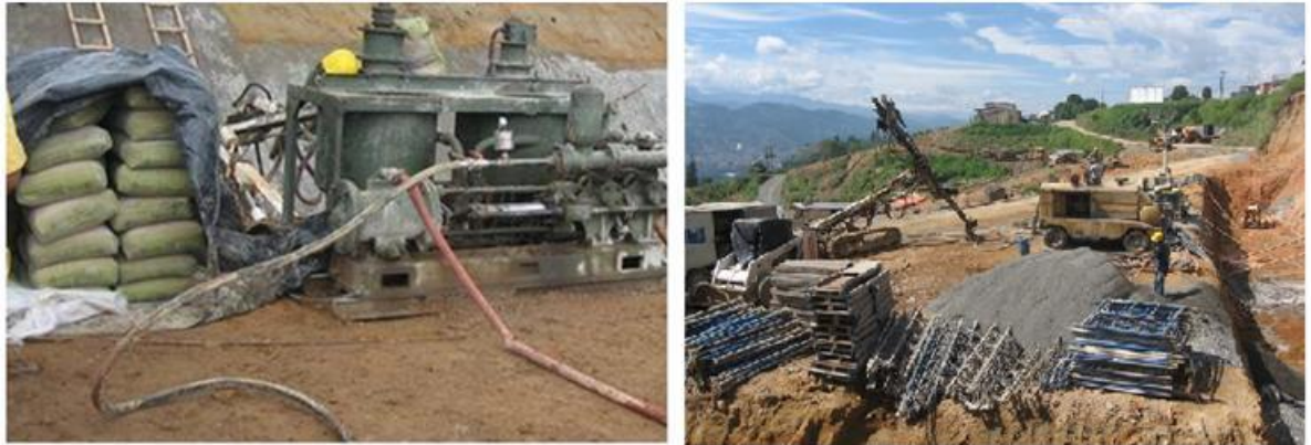
Figura 14. Izq: cemento expuesto a intemperie Der: Almacenamiento de agregados
