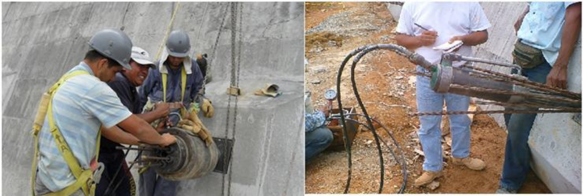
Figura 37. Izq: Gato hidráulico multi-torón
