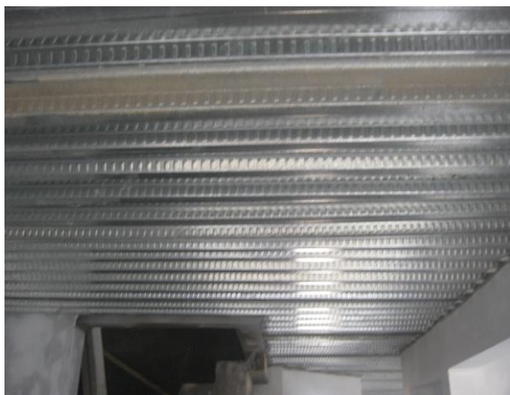
Figura 73. Cielorraso sin perlita
