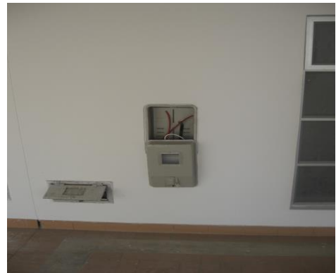
Figura 106. Interruptor de la calle
