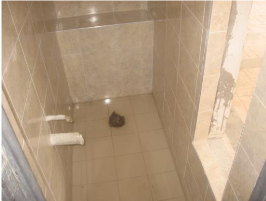
Figura 100. Tubería donde va ubicado el Lavamanos Del baño social (primer piso)
