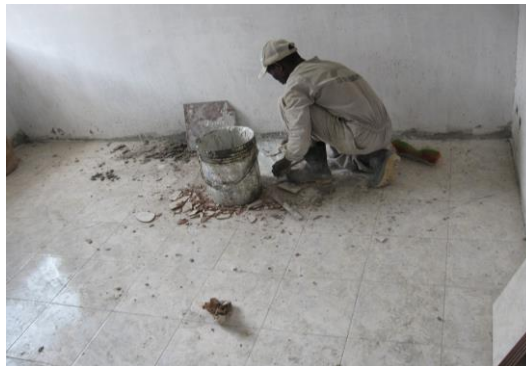
Figura 38. Cambio de piso cerámica mal puesta
