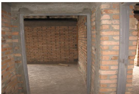
Figura 4. muros sin repellar
