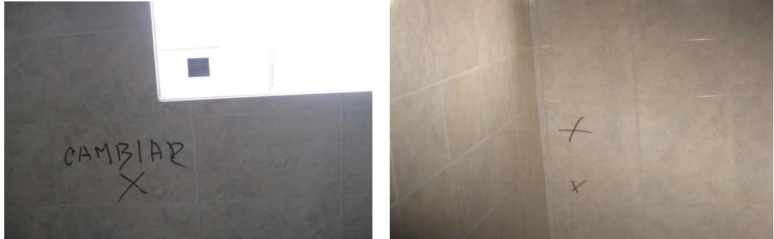
Figura 28 y 29 Enchape mal puesto en los muros
