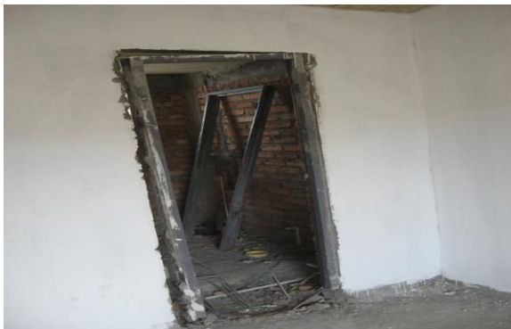
Figura 10. Dilataciones sin terminar
