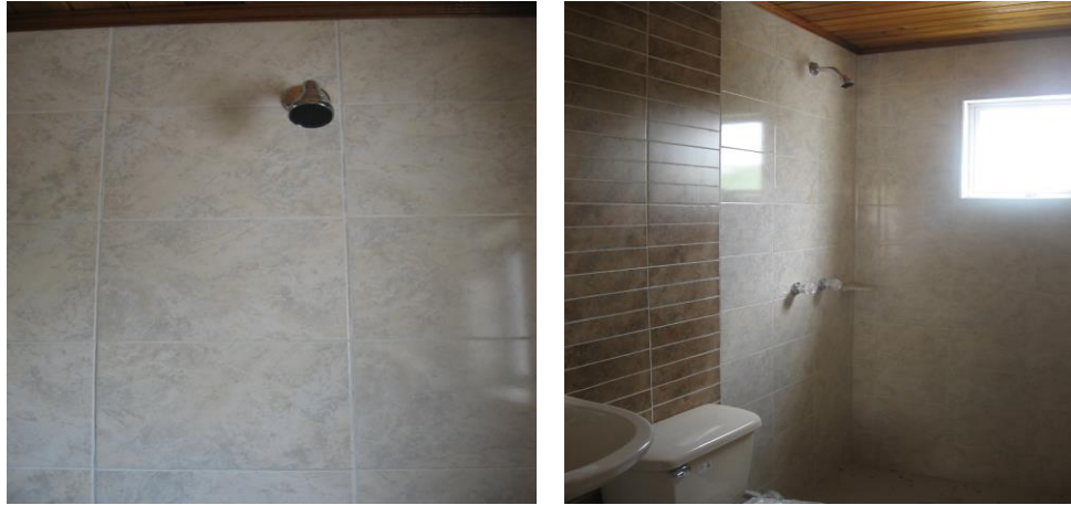
Figura 96. Y 97. Duchas instaladas
