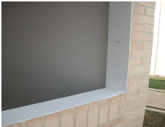
Figura 17. Estuco plásticos en ventanas
