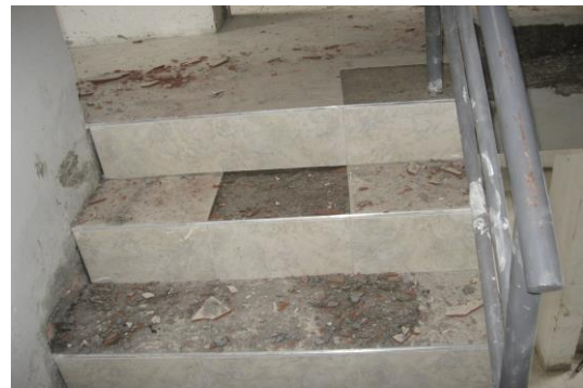
Figura 37. Piso cerámica mal puesta
