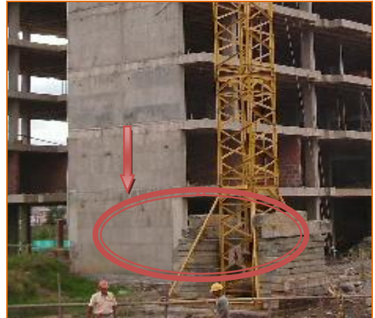
Figura 88. Muertos de la Torre grúa
