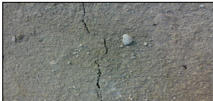
Figura 76. Fisura debida a un curado inadecuado
