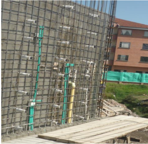
Figura 97. Instalaciones eléctricas y a gas.
