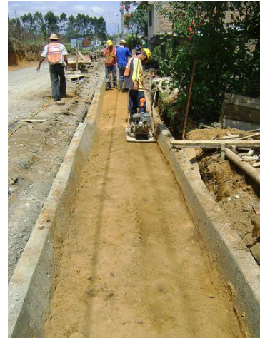
Continúa con el relleno estructura con material de sitio PR0+745 – PR0+780 (MD)
