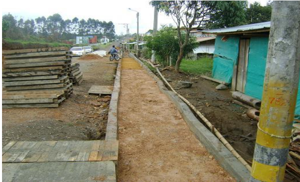
Continúa con el relleno estructura con material de préstamo espesor = 10cm PR0+780 – PR0+830 (MD)
