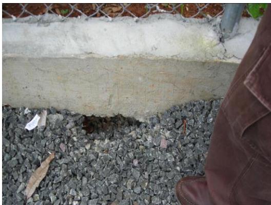
No se colocó solado de limpieza. En este caso se continuó con el proceso constructivo y para los siguientes sitios se exigió su colocación.
