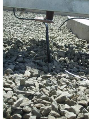
Aterrizaje platina debajo de escalerilla portacable al sistema de puesta tierra
