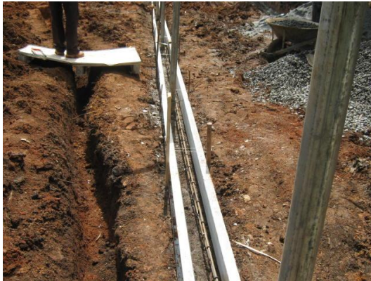
Formaleta mal retirada. Se recubrió el hormiguo con lechadas de cemento.
