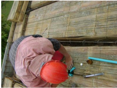
Figura No. 139 Instalación eléctrica
