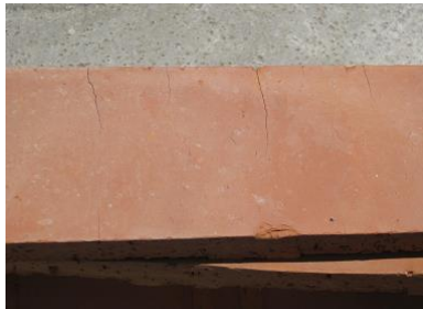
Figura No.40 Fisuras encontradas en algunos ladrillos
