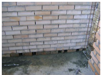
Figura No. 117 Ventanas de inspecci3n
