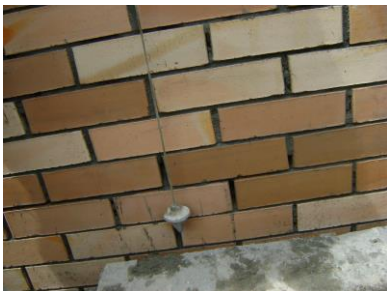
Figura No. 116 Plomo del muro
