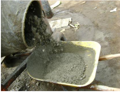
Figura No. 147 Mezcladora del concreto
