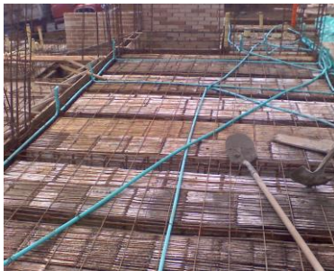
Figura No. 141 Instalaciones eléctricas
