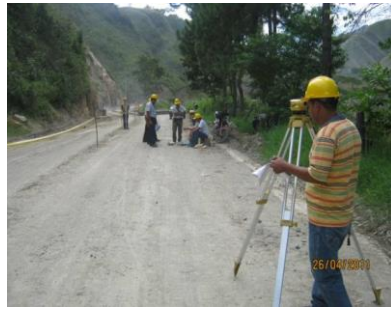
FIGURA 51. VISTA DE ACTIVIDAD DE CHEQUEO DE NIVELES DE LAS CAPAS DE PAVIMENTO
