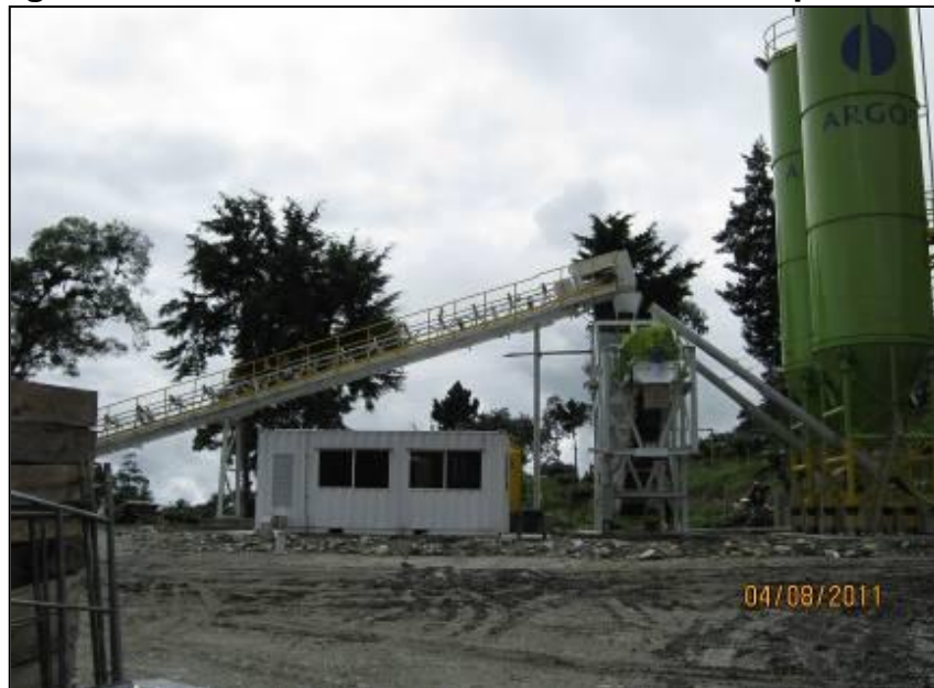
Figura 17. Planta de Concreto Tramo Gabriel López – Inzá.
