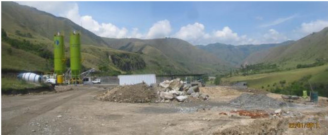
Figura 18. Planta de Concreto Tramo La Plata – Inzá.
