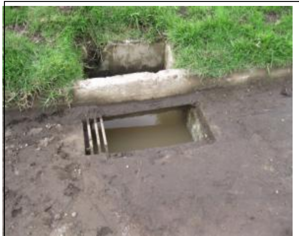
Sumidero en mal estado
