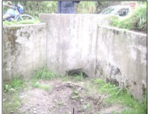
Alcantarilla sin funcionamiento
