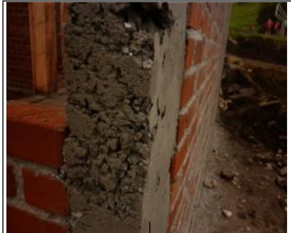
Columna mal elaborada- necesita corrección
