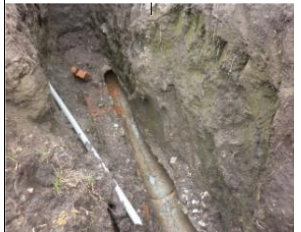
Alcantarillado en mal estado
