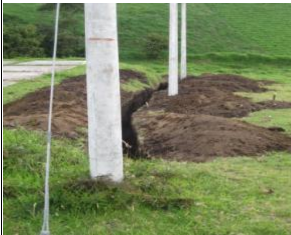
Antiguo alcantarillado-mal ubicado
