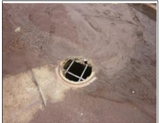
Tapa de alcantarillado mala
