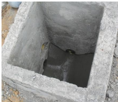
Figura No. 49 Caja de inspección con cañuela
