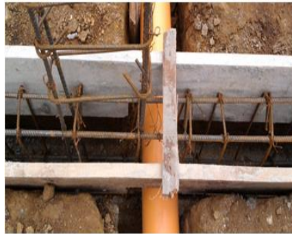
Figura No. 42 Chequeo de separación del acero a la formaleta, la verticalidad y alineación de los tableros
