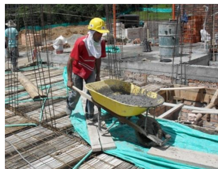
Figura No. 85 Protección del recorrido de los buggis
