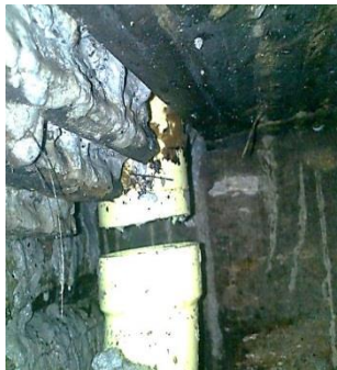
Figura No. 14 Tubería rota
