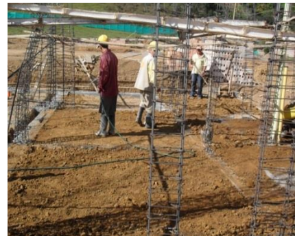
Figura No. 56 Compactación del material de manera gradual hasta el nivel de la viga
