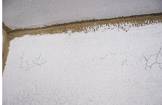
Figura No. 13 Estuco agrietado
