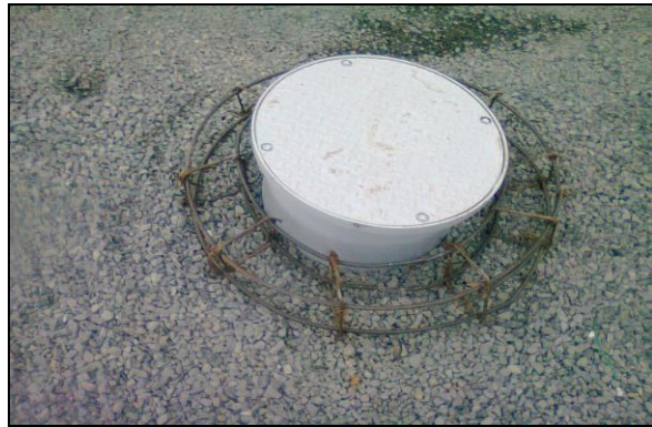
Foto 52. Material sin compactar
