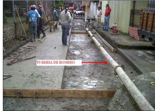
Foto 13. Tubería de bombeo
