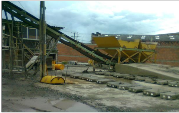
Foto 69. Tolvas de recepción de materiales
