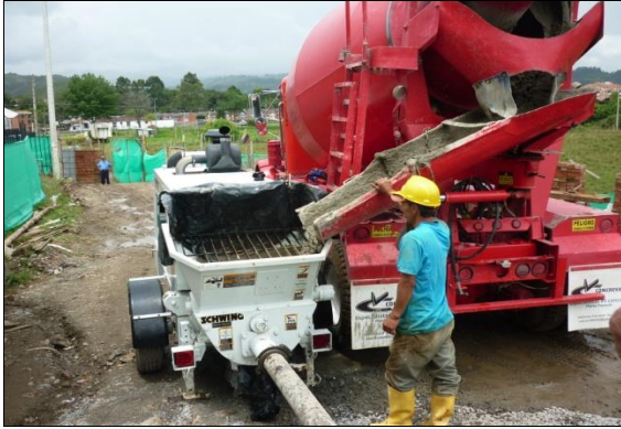
Foto 12. Equipo de bombeo
