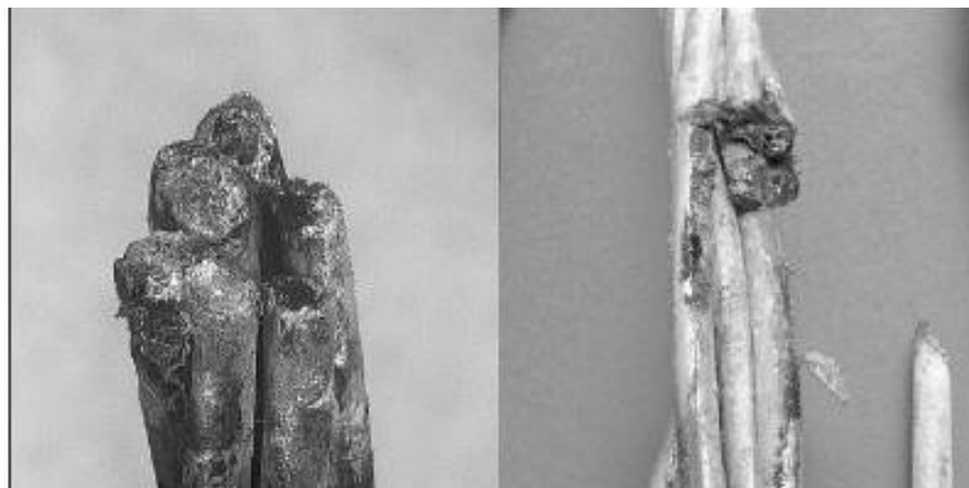
Imagen 11. Patologías del torón: aplastamiento, Destoronamiento y oxidación
