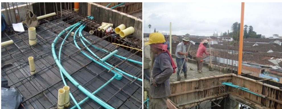
Fig. 8.78. Caja de entrada de tubería proveniente del piso anterior.
