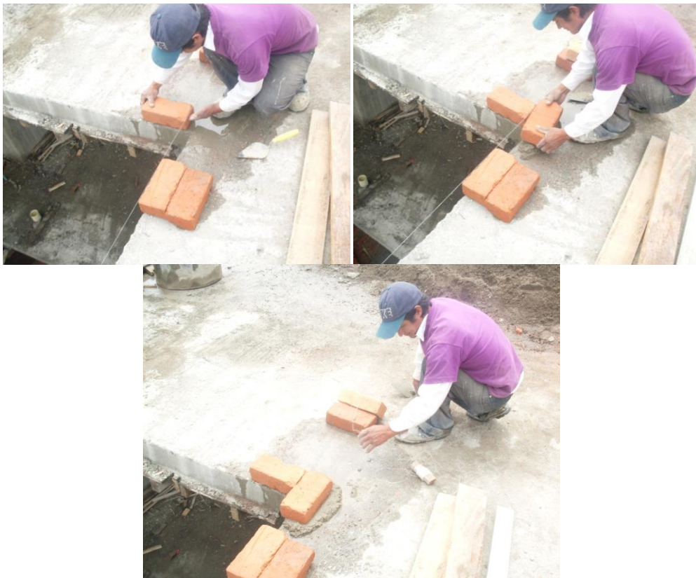
Fig. 8.62. Con la ayuda de ladrillos templamos el hilo y colocamos ladrillos guía.
