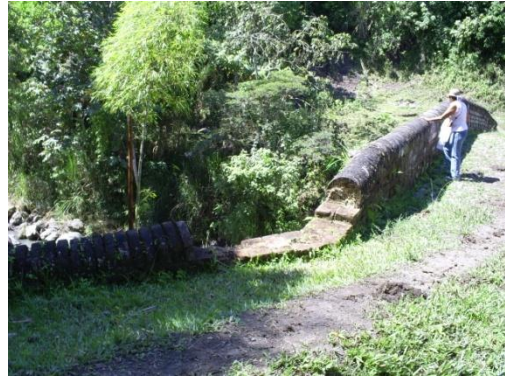
Fig. 65. Pérdida de la mampostería de la baranda.
