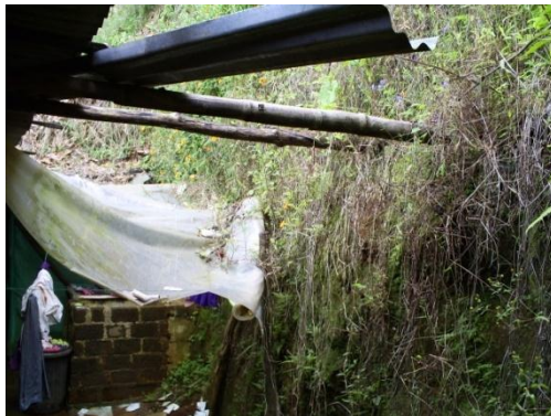
Fig. 3. Cercanía del talud a la vivienda en riesgo.
