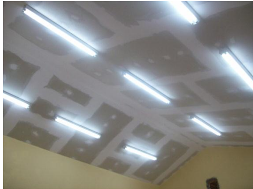
Fig. 15. Cielo raso en el interior del aula con la iluminación en funcionamiento.
