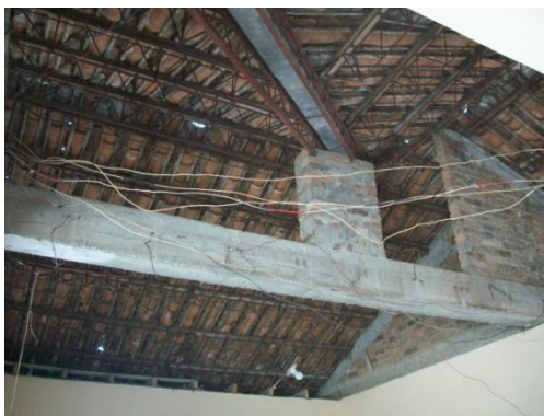
Fig. 11. Estado de vigas y culatas de soporte a las correas.
