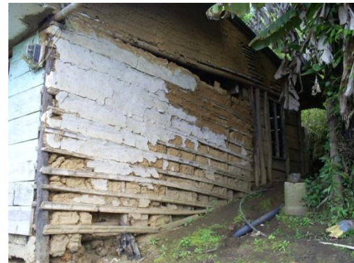
Fig. 4. Notorio deterioro en la estructura de la vivienda.
