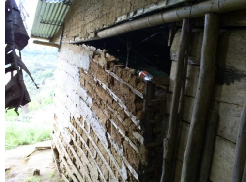
Fig. 2. Notorio deterioro en la estructura de la vivienda.
