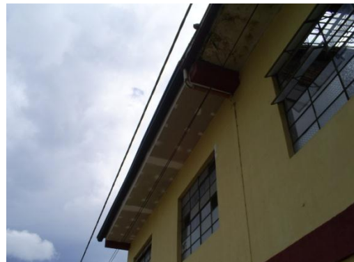
Fig. 18. Cielo raso en fibro cemento y canaleta instalada y en servicio.
