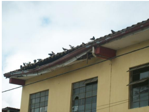
Fig. 9. Colapso del cielo raso y la canaleta de aguas lluvias.
