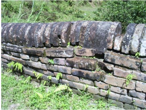
Fig. 66. Deterioro en la estructura de la baranda del puente.
