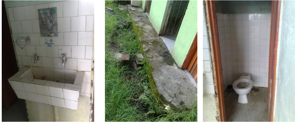
Figs. 44, 45 y 46. Aspecto de los baños antes de realizar la intervención.
