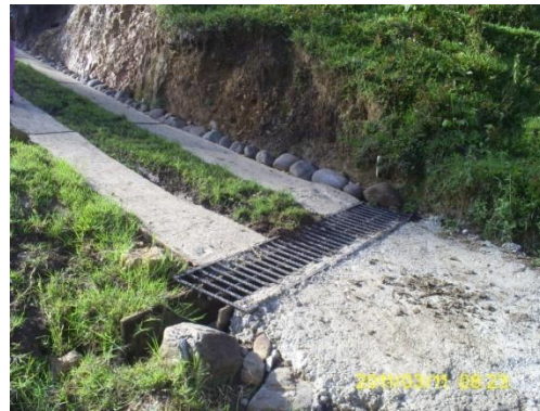
Fig. 59. Vía que acumula y deposita las aguas de escorrentía.
