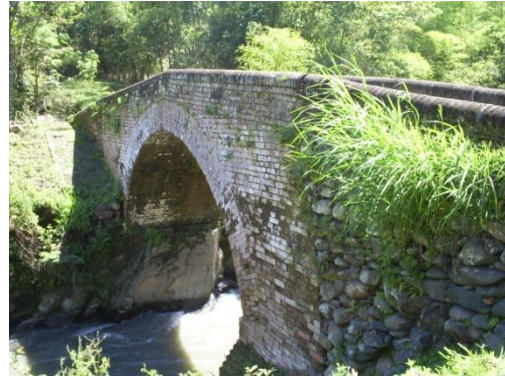
Fig. 67. Influencia de la maleza sobre la estructura de puente.
