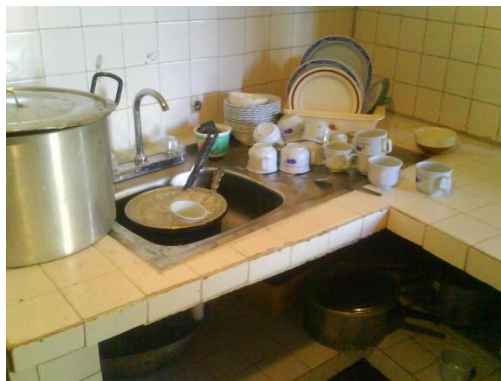
Fig. 49. Lavaplatos metálico instalado y en servicio.
