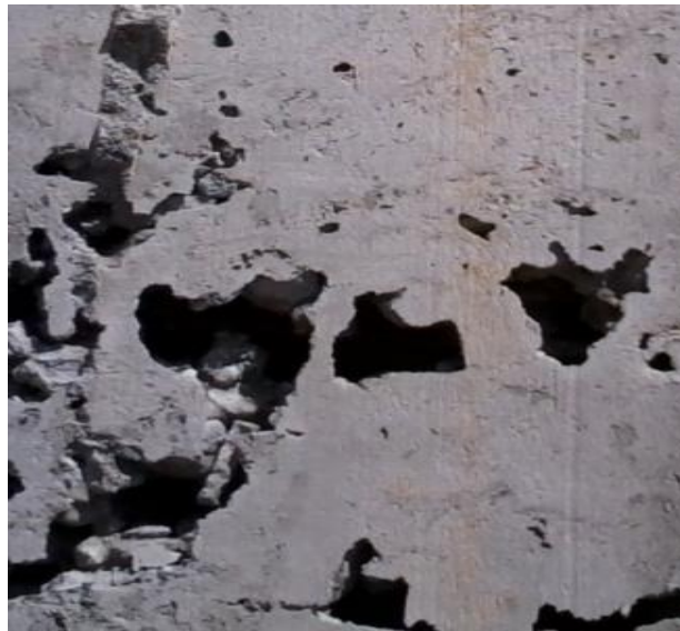
Figura 45. Cimiento que requiere demolición.
