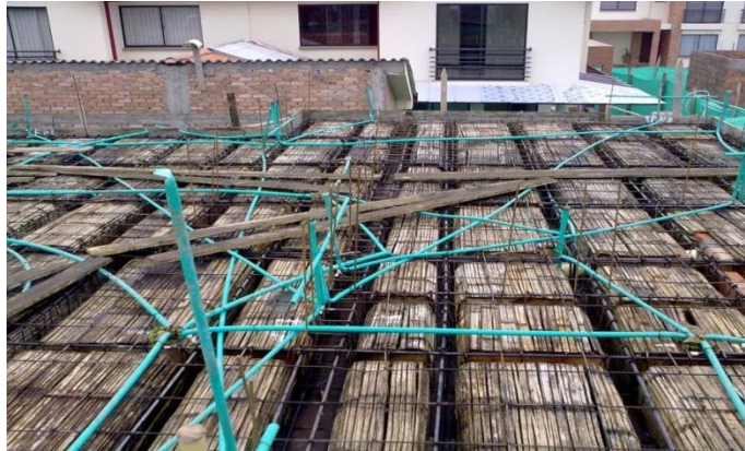
Figura 33. Tubería para cableado eléctrico y malla de acero para retracción y temperatura.
