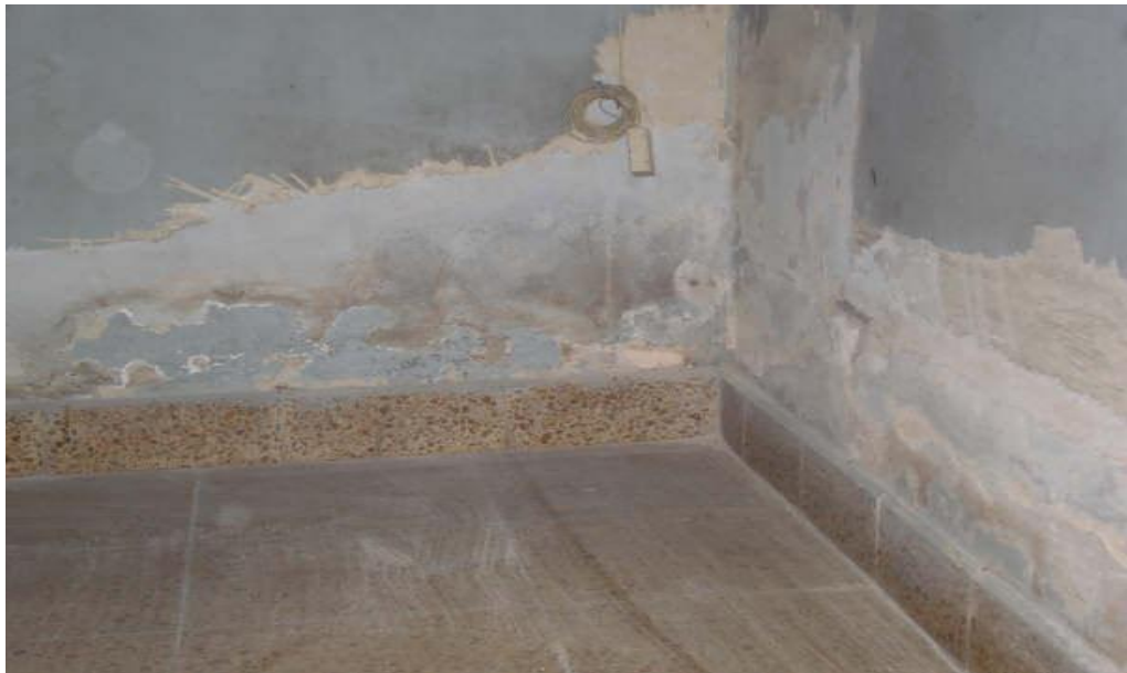
Figura 51. Humedad en muros de la casa 35.
