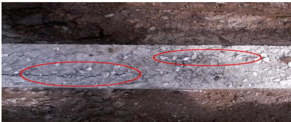
Figura 47. Falla por retracción y temperatura del concreto.
