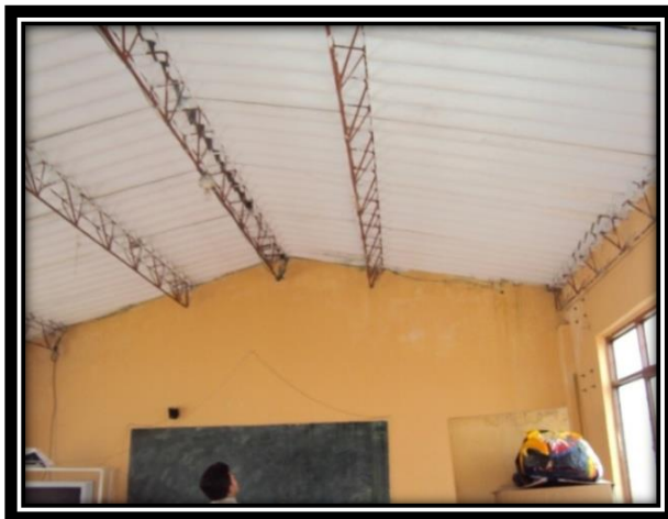
Foto 10. Humedad en las paredes
