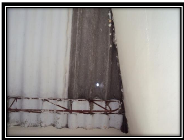
Foto 9. Goteras en la cubierta
