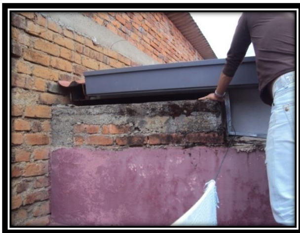
Foto 11. Canal de aguas lluvias
