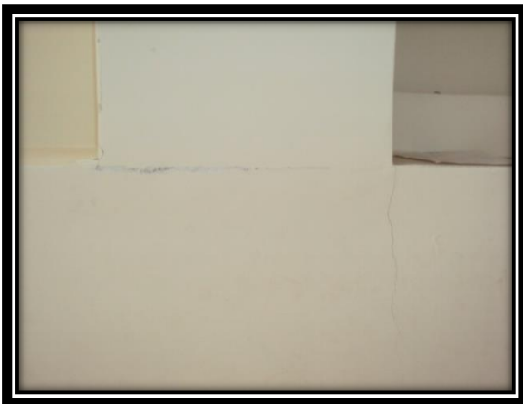
Foto 2. Fisuras en el acabado
