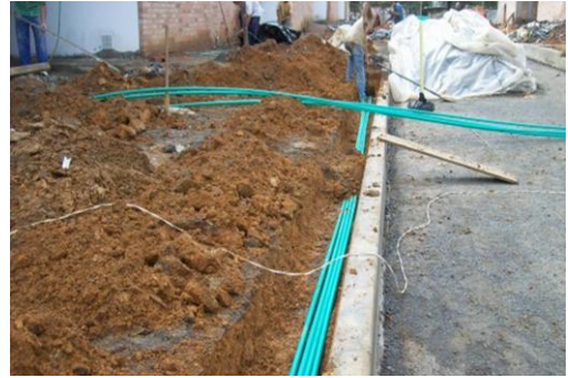
Foto 120 Redes domiciliarias de teléfono y televisión
