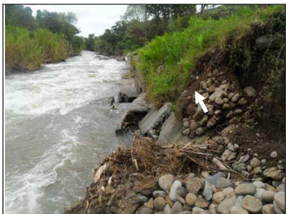
Foto 37. Detalle del deterioro de uno de los gaviones
