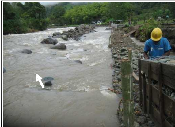
Foto 15. Afectación en la zona de trabajo.
