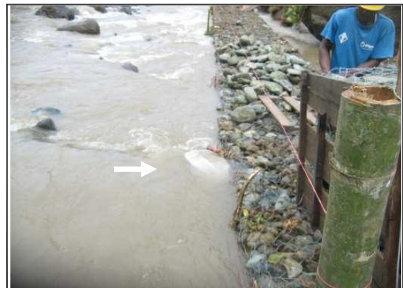
Foto 16. Nivel cercano a la corona del gavión.
