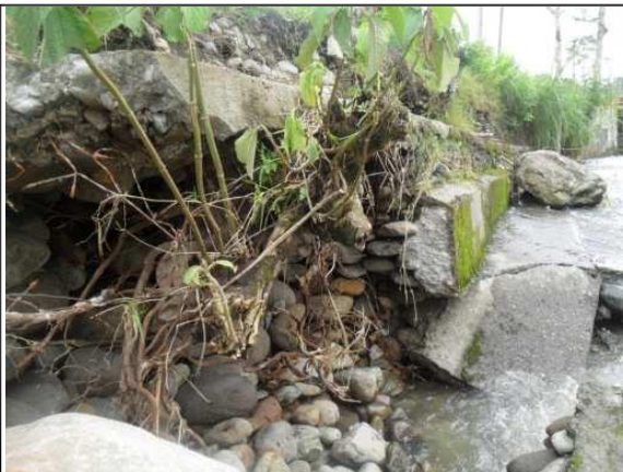
Foto 38. Otra vista de deterioro.
