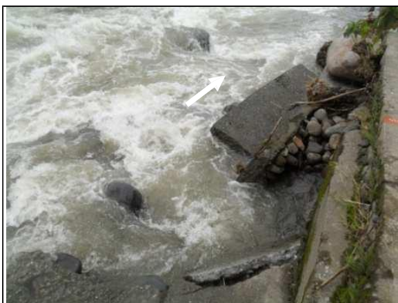
Foto 34. Desprendimiento de fragmentos de gavión.
