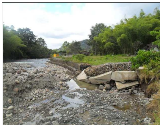
Foto 41. Estado gaviones en litigio
