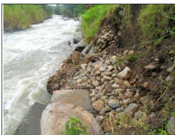
Foto 36. Inclinación y colapso de un cuerpo de gavión.
