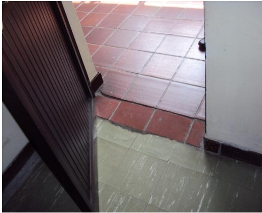
Foto N° 12. Hundimiento en el primer piso
