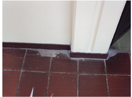
Foto N°13. Grietas generadas alrededor de columnas 1° piso.
