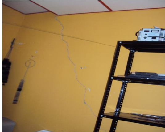
Fig. 16 Foto N°3 muro localizado paralelo a los ejes 9-10
