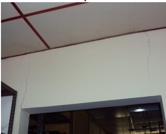
Fig. 17 Foto N° 4 muro perpendicular a los ejes 9-10
