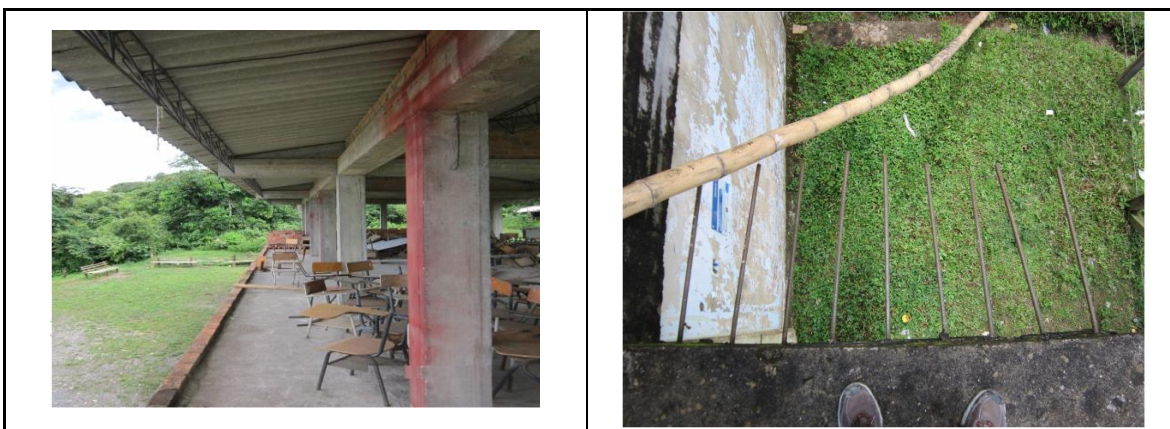
Ausencia total de baranda y escaleras para acceder al segundo piso, lo que genera espacios inseguros e inhabilita las aulas en este nivel.
