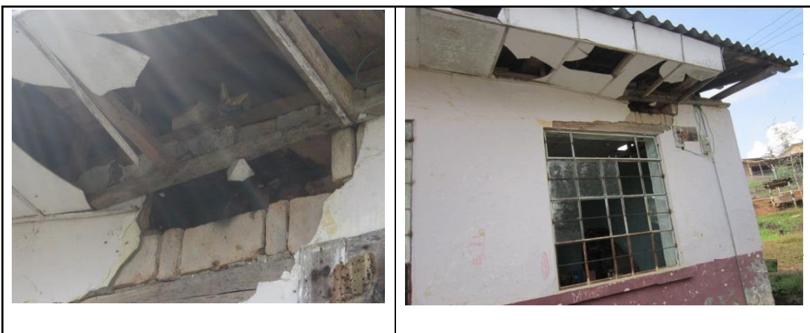
Muros sin confinamiento y fachadas en mal estado
