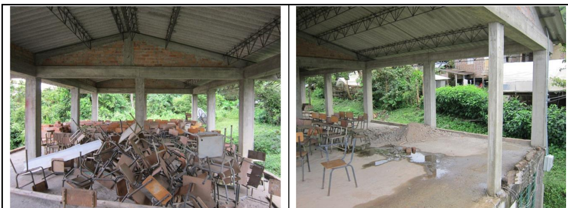
Ausencia total de muros divisorios en segundo piso, se aprecia como el agua lluvia está afectando la losa, proyectando humedad hacia el cielo del primer piso
