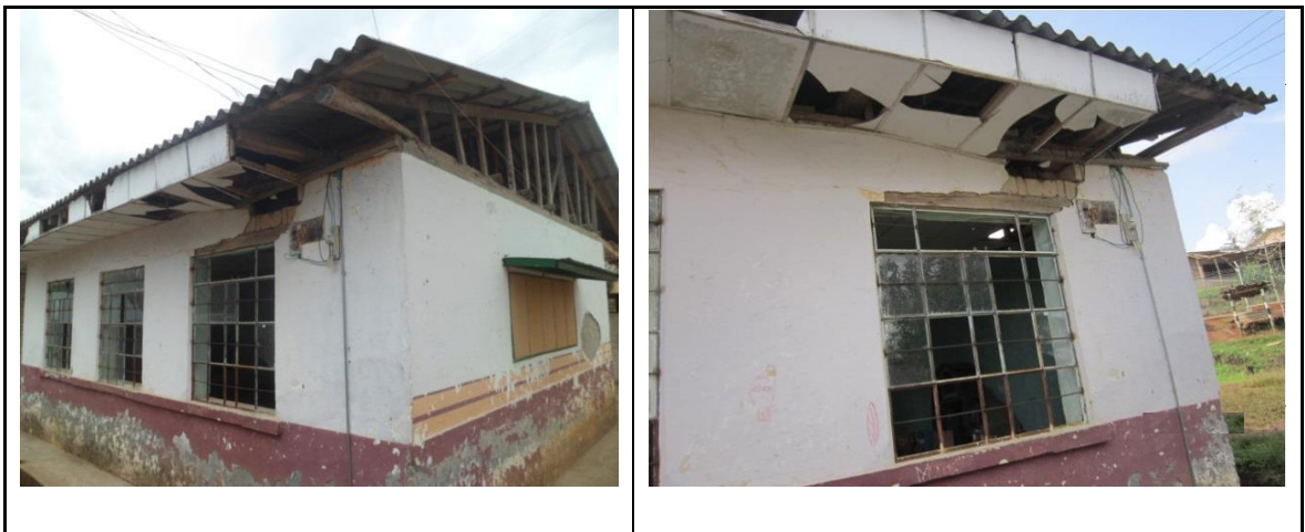
Completo deterioro de la estructura de cubierta y de la mampostería de la biblioteca, sala de cómputo y salón de clases continuo a biblioteca.
