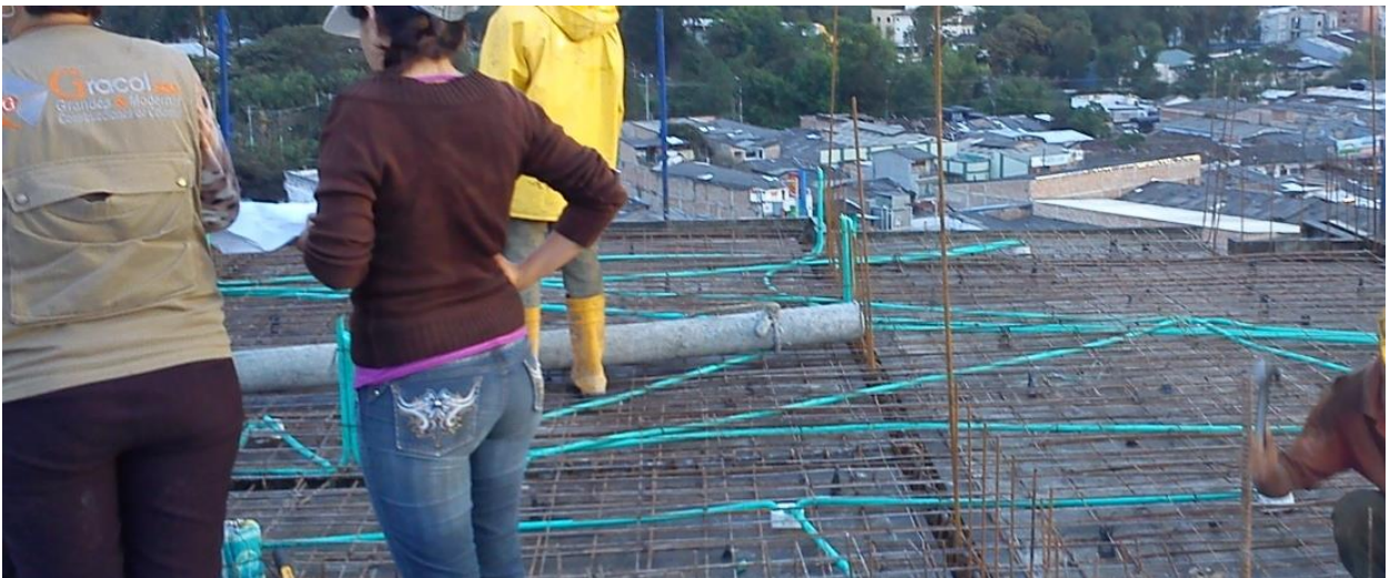
Figura 75 Instalaciones eléctricas apartamento 1 piso 1
