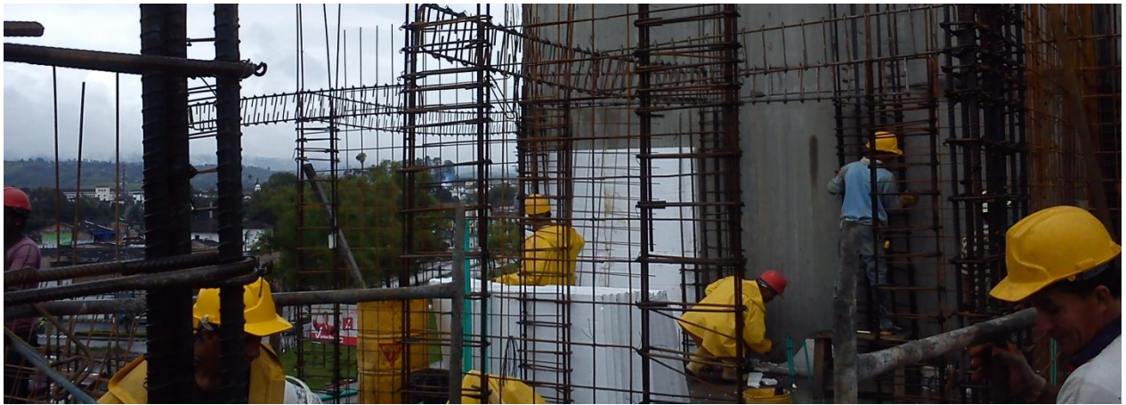
Figura 67 Control de calidad apartamento 1 piso 1
