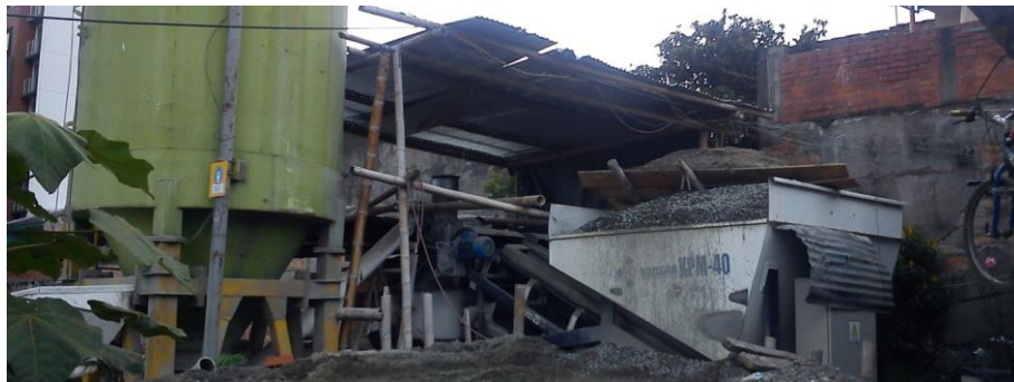
Figura 27 Tanques de aditivos y tanque de agua
