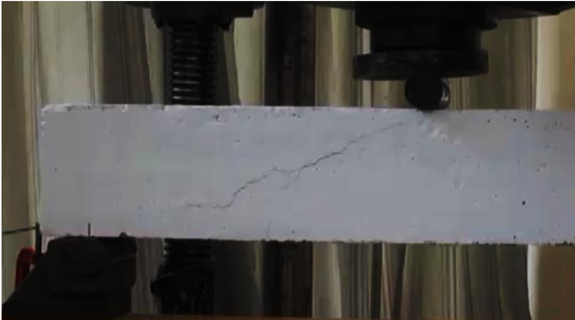
Fig.60. Fisura más ancha en dirección al punto de aplicación de la carga
