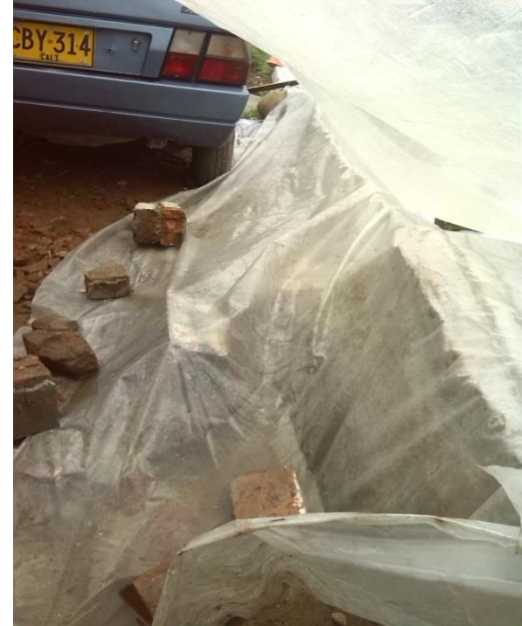
Figura 17-18. Filtraciones de agua procedentes del parqueadero de la vivienda colindante
