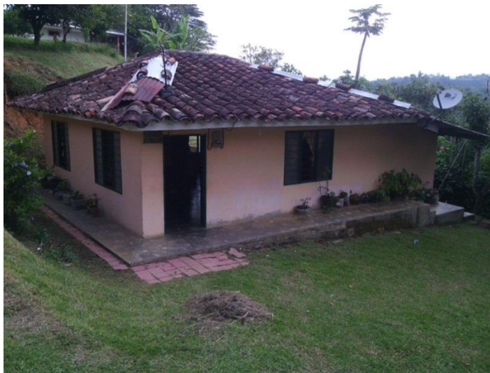
Figura 6. Vivienda de la familia afectada por el asentamiento
