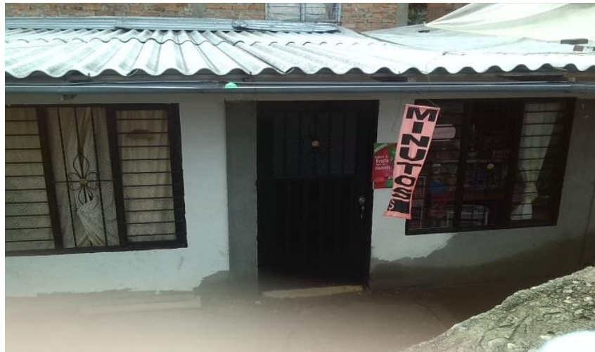
Figura 14. Fachada principal de la vivienda afectada
