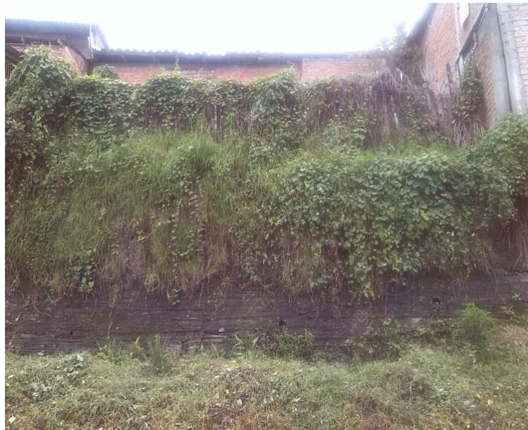
Figura 21-22. Muro existente en concreto ciclópeo en mal estado y sin mantenimiento
