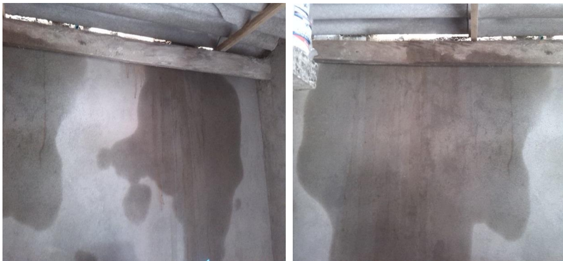
Figura 15-16. Filtraciones de agua por las paredes
