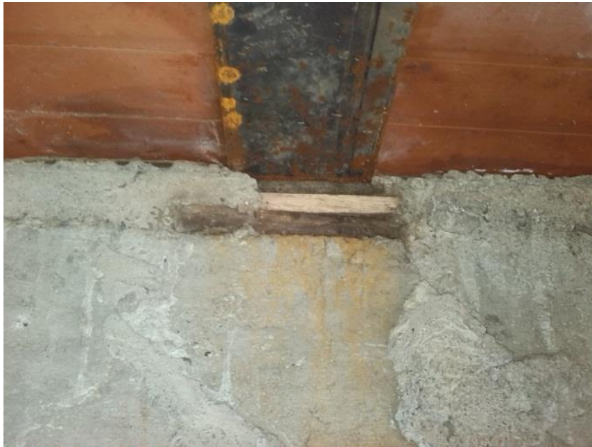
Figura 2. Trozos de madera soportando la carga de la losa de entripiso
