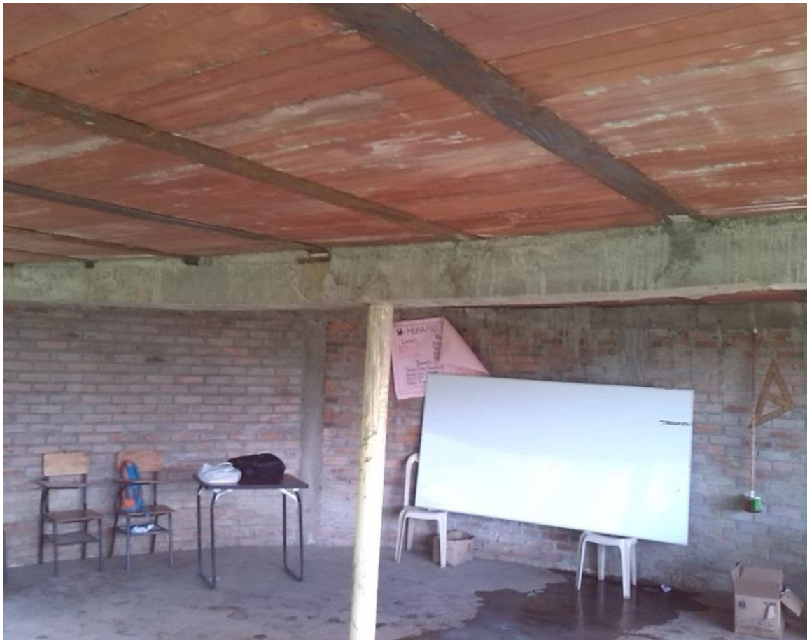
Figura 1. Viga central pandeada
