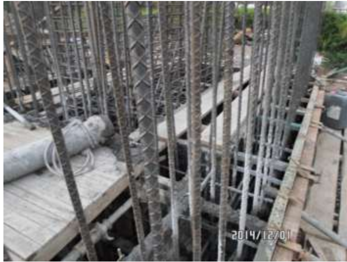
IMAGEN 84 – FUNDICION PARCIAL DE CAJON Y MURO DEL VASTAGO IZQUIERDO – PASARELA – ESTRIBO No.1
