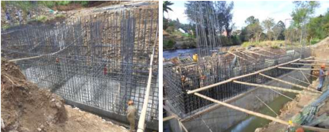
IMAGEN 4 – INSTALACION DE ACERO DE REFUERZO Y FUNDICION EN UN PRIMER NIVEL PILA CENTRAL
