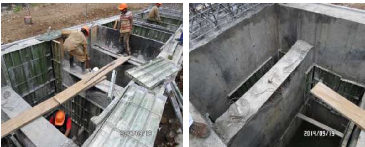
IMÁGENES 17 - PROBLEMA EN TABIQUES PILA CENTRAL
