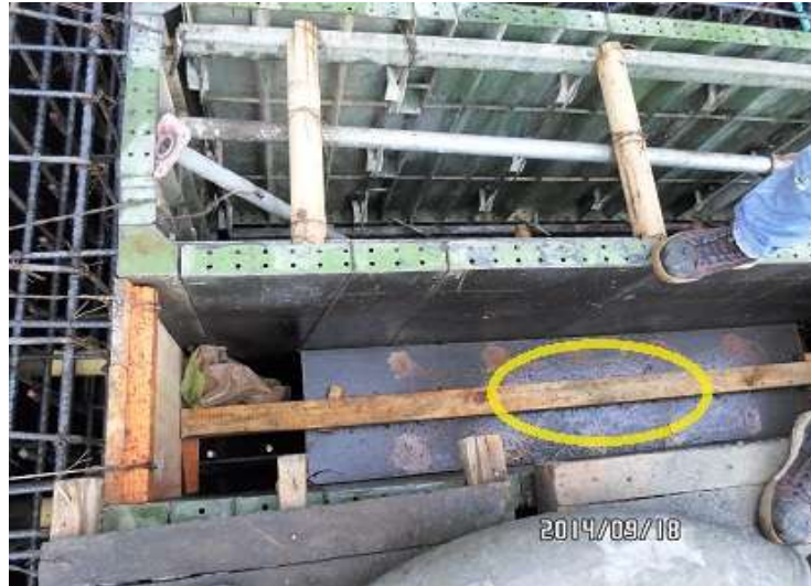
IMAGEN 16 – ILUSTRACION DE ESPACIO REDUCIDO POR PLATINA Y FORMAleta, Y LUGAR DONDE NO SE VACIO CONCRETO
