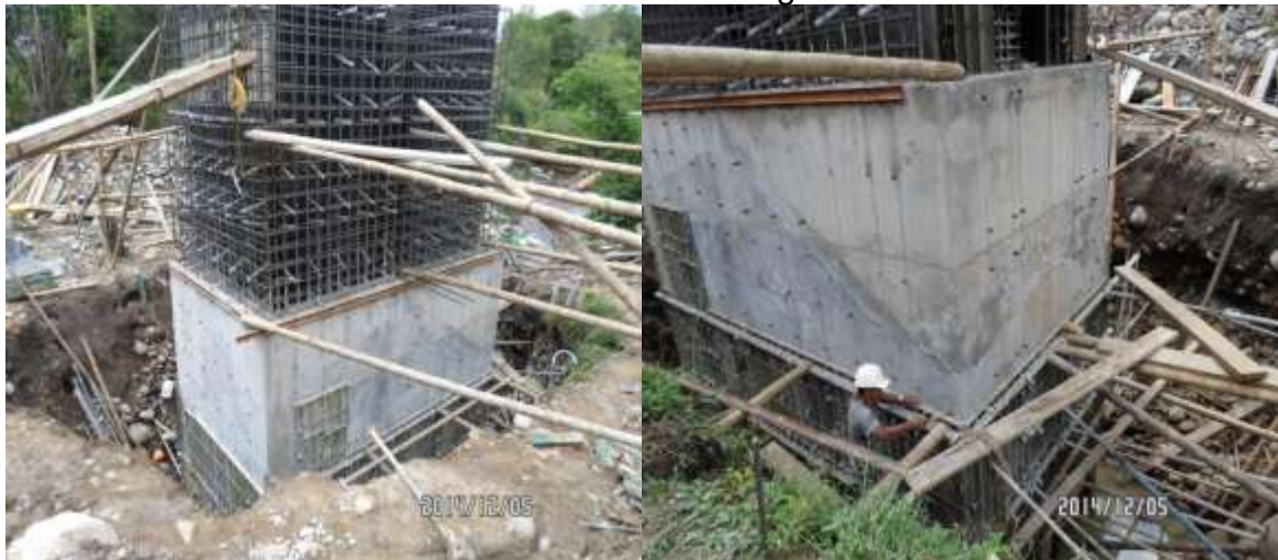
IMÁGENES 85 - RETIRO DE FORMALETA METÁLICA MURO DEL VÁSTAGO Y CAJÓN IZQUIERDO PRIMER NIVEL ESTRIBO No. 1
