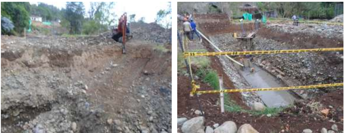
IMAGEN 34 – EXCAVACION Y FUNDICION DE SOLADO DE LA CIMENTACION DEL ESTRIBO No. 3 K0+165.32
