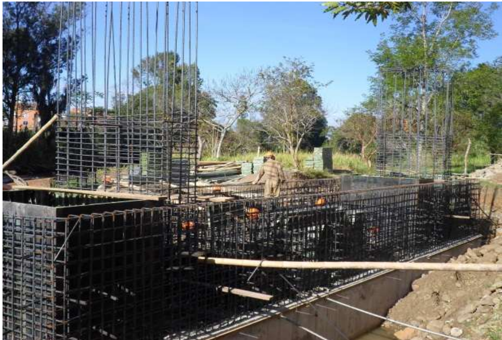
IMAGEN 10 – INSTALACION Y AMARRE DE ACERO DE REFUERZO CAJON Y VASTAGO PILA CENTRAL
