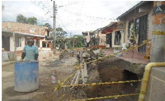
Figura 13. Sobre excavación para construcción de acometidas domiciliarias
