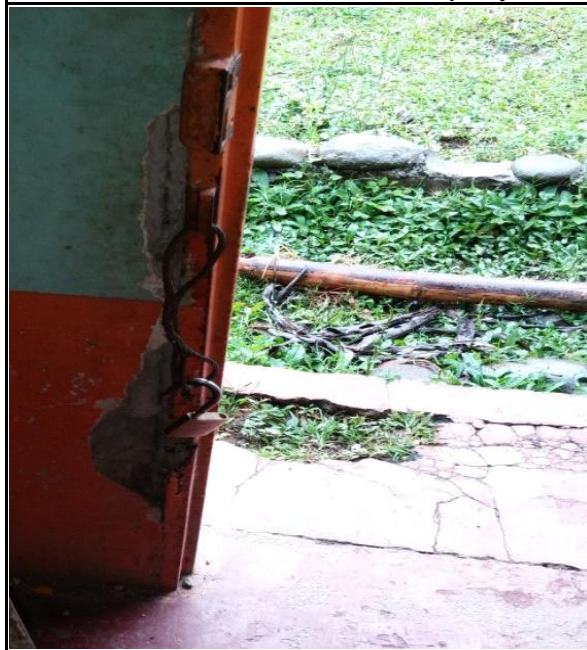
Muros en mal estado
