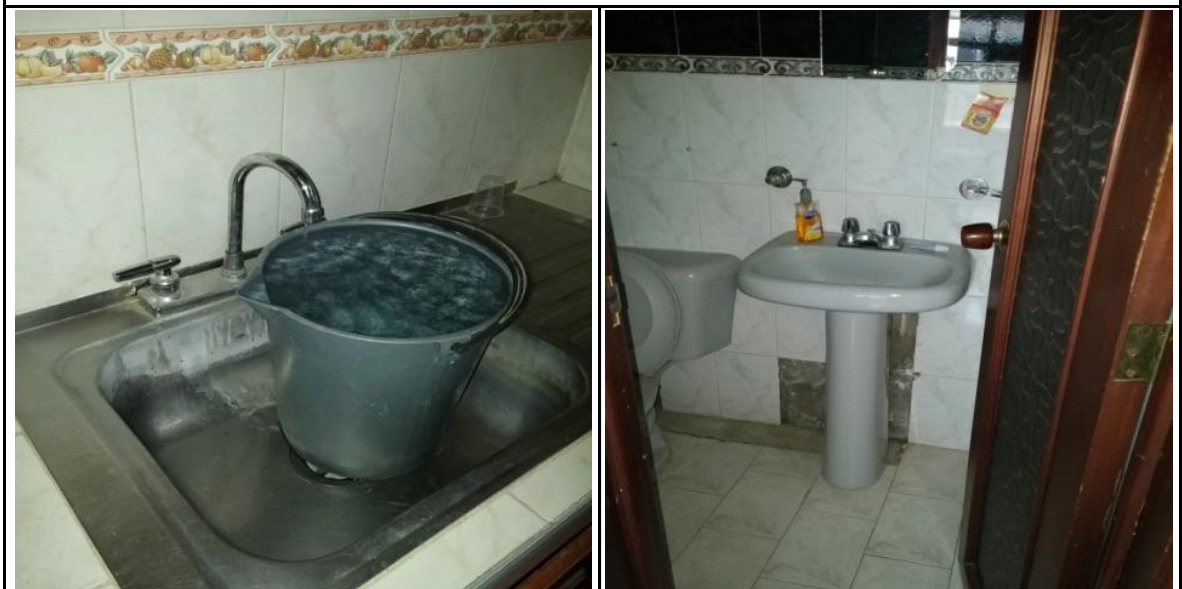
Fuga en el lavaplatos
