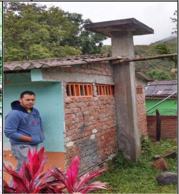
Ausencia de tanque de almacenamiento
