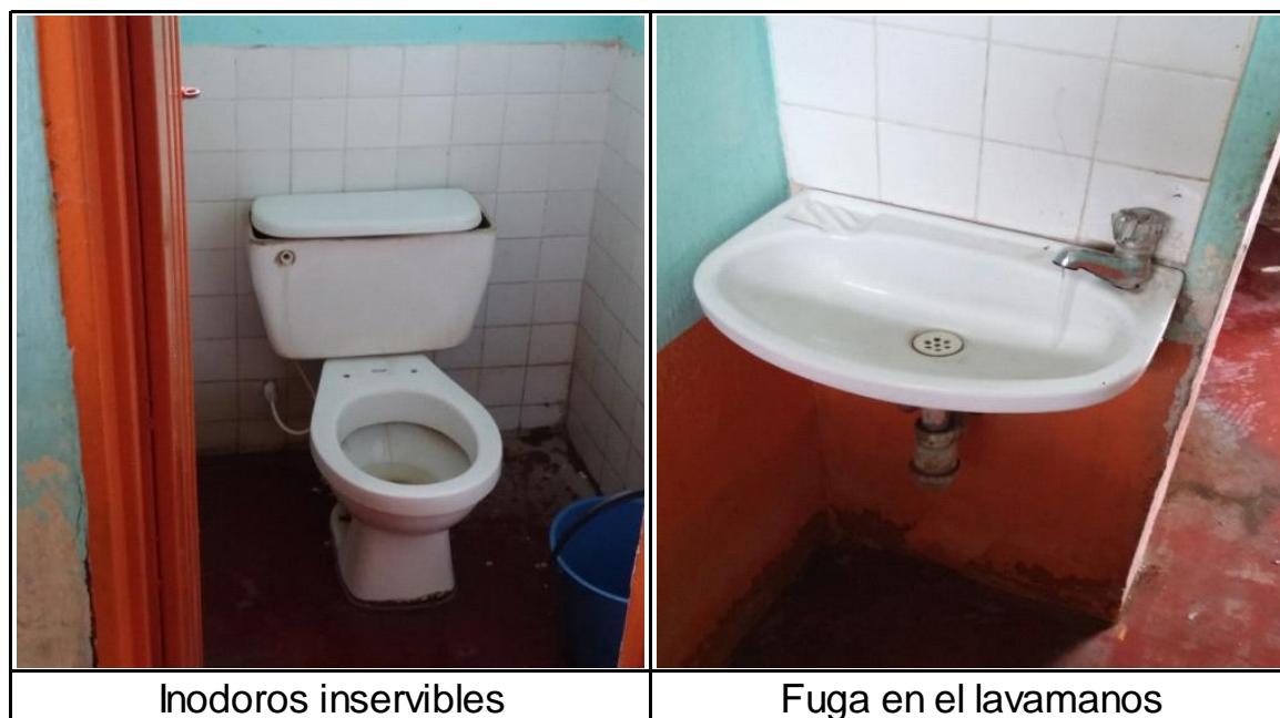
Imagen 11. Instalaciones hidrosanitarias en mal estado (Fuente: Autoría propia)
