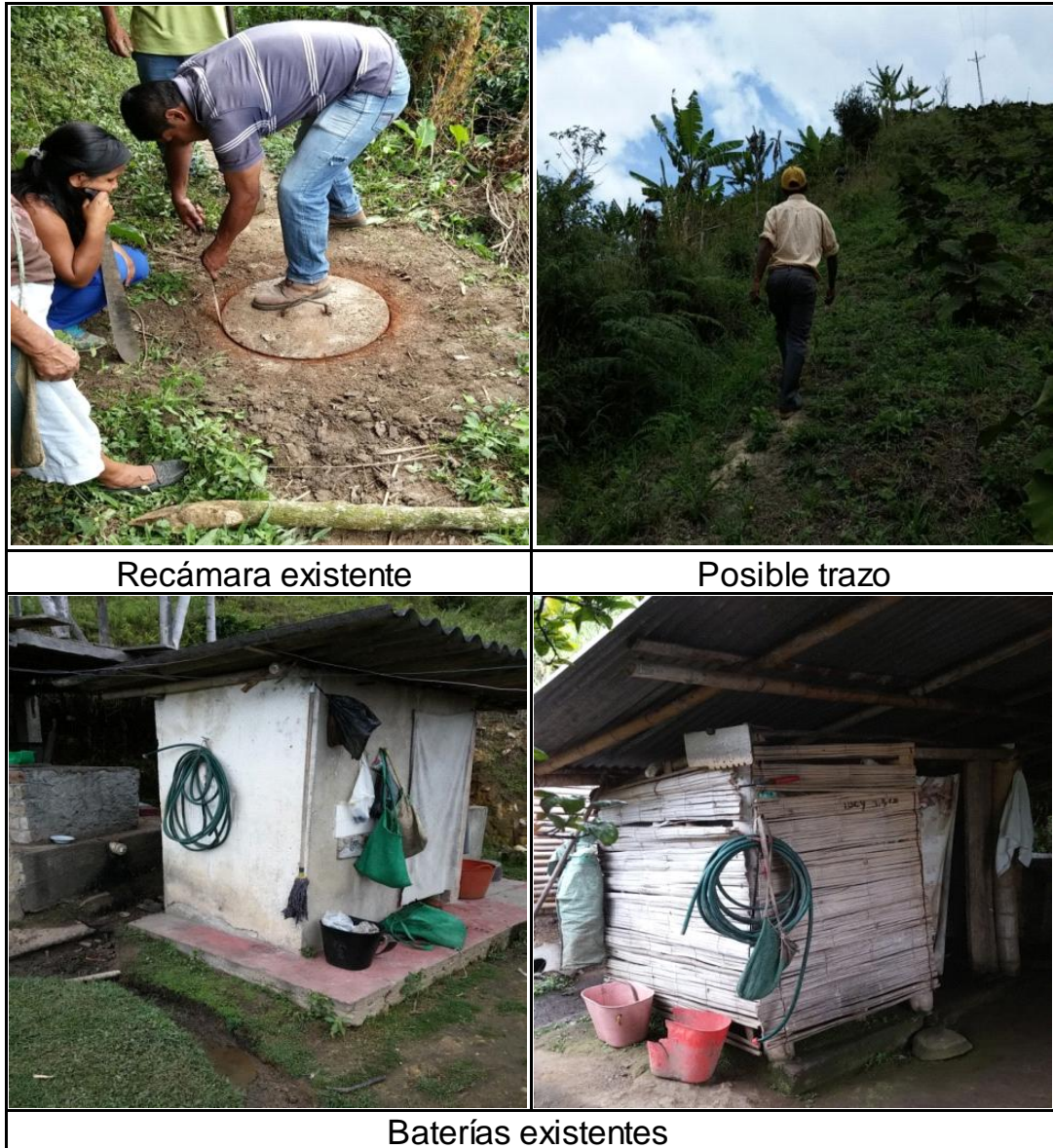
Imagen 17. Replanteo ampliación sistema de alcantarillado de la vereda Potrero del Barro (Fuente: Autoría propia)
