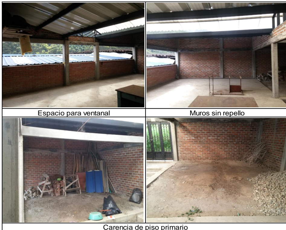
Imagen 14. Estado segundo piso Centro Cultural Avenida Santander (Fuente: Autoría propia)
