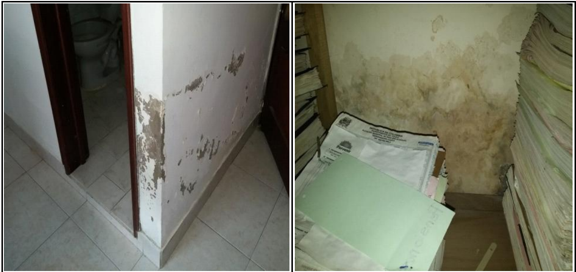
Humedad en muros
