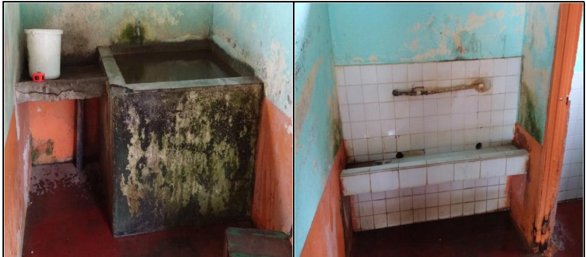
Tanque y orinal antihigiénicos
