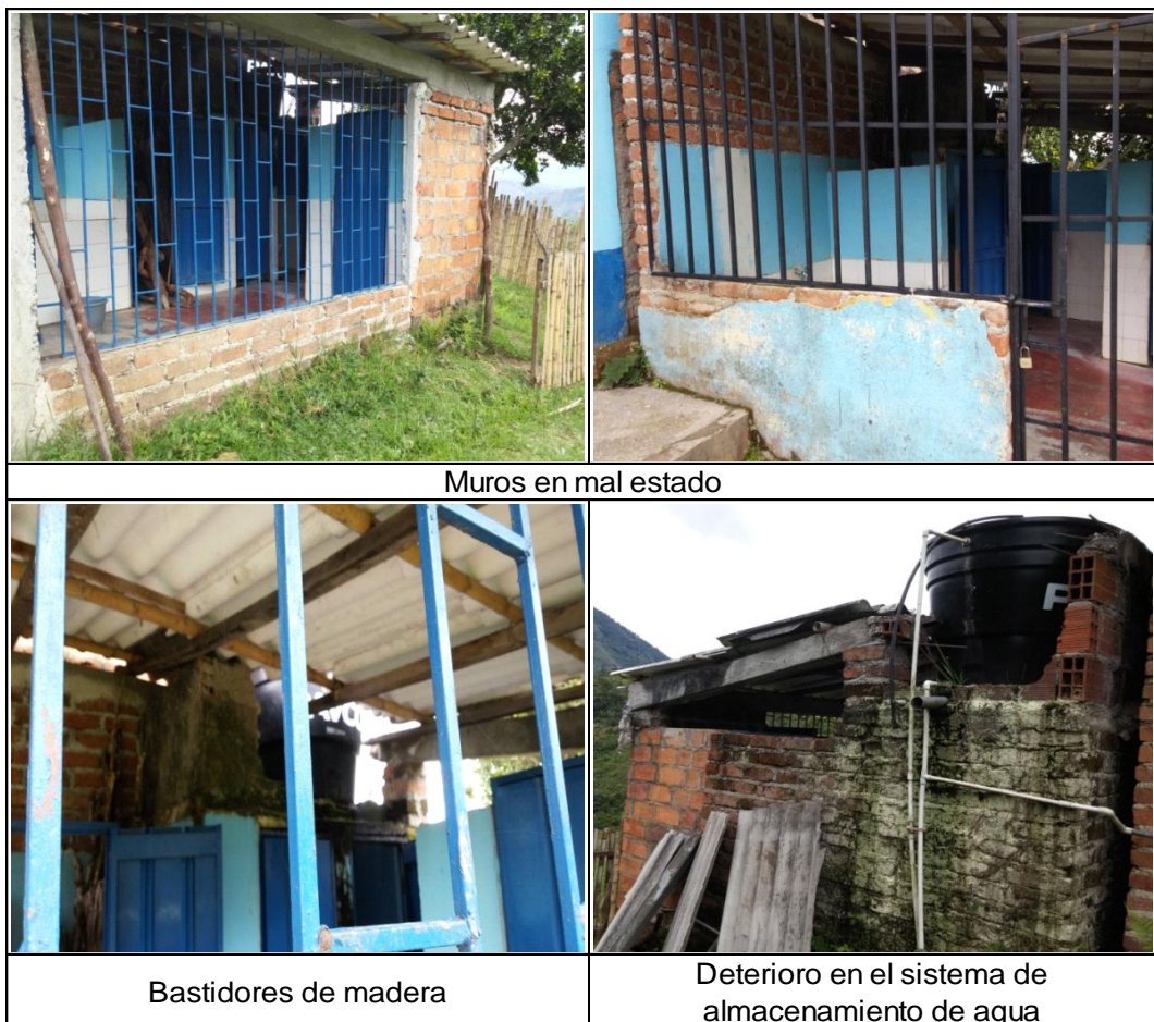
Imagen 15. Estado batería sanitaria Escuela Rural Mixta San Antonio de Guaiquite (Fuente: Autoría propia)
