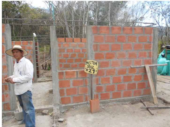
FIGURA 39. Foto columnas en concreto terminadas. Pastor Díaz Avilés. Beneficiario La Balsa – Municipio de Páez. Fuente: Archivo Rafael Carvajal
