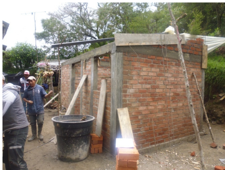
FIGURA 36. Foto construcción viga cinta. Inocencio Sánchez Benachí. Beneficiario Salado Blanco - Totoró. Fuente: Archivo Rafael Carvajal
