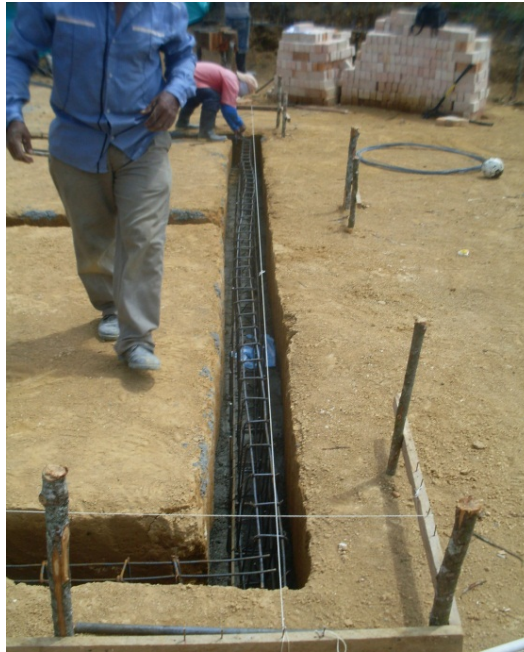
FIGURA 24. Foto excavación a mano, solado de limpieza y arreglo de hierros de cimentación. Sector La esperanza – Municipio de Popayán. Fuente: Archivo Rafael Carvajal
