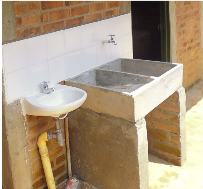
FIGURA 41. Foto lavamanos y lavadero prefabricado con enchape. Dionisio Zambrano Yunda. Beneficiario Bella Vista - Totoró. Fuente: Archivo Rafael Carvajal
