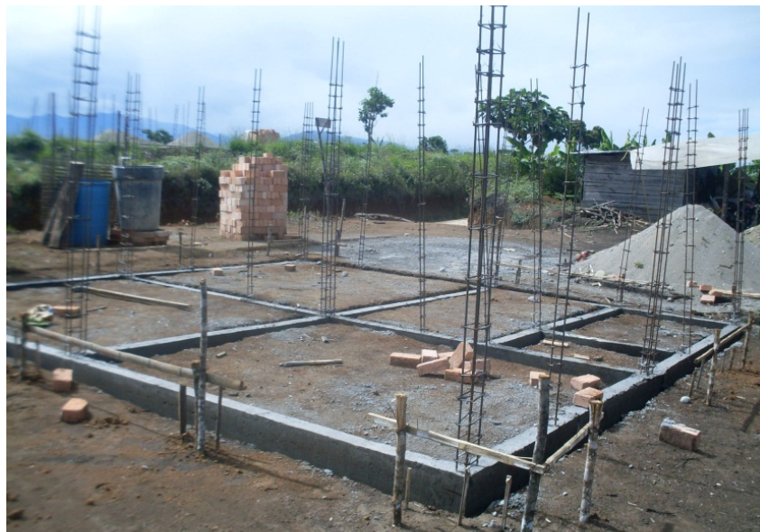
FIGURA 25. Foto viga de cimentación completa. Segundo Javier Mora. Beneficiario Municipio de Morales. Fuente: Archivo Rafael Carvajal
