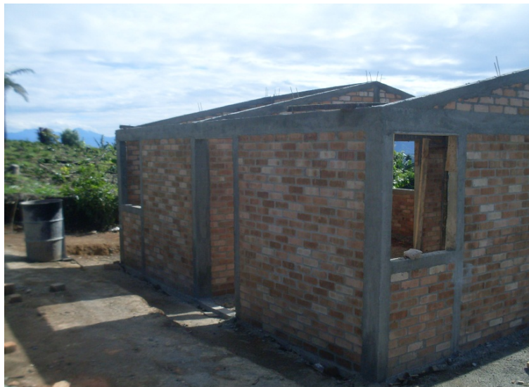
FIGURA 38. Foto viga cinta terminada. Nivelso Antonio Ussa Paja. Beneficiario El Danubio - Morales. Fuente: Archivo Rafael Carvajal
