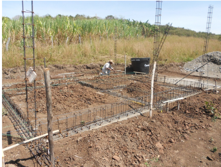
FIGURA 26. Foto viga de cimiento 25x20 cm. José Julio Aley. Beneficiario La Balsa – Municipio de Páez. Fuente: Archivo Rafael Carvajal
