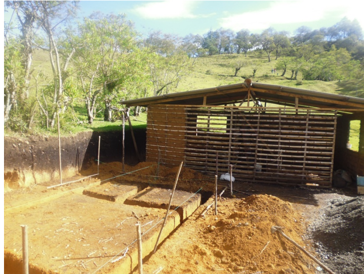
FIGURA 22. Foto excavación a mano. Victor Manuel Yunda. Beneficiario Jebalá Totoró. Fuente: Archivo Rafael Carvajal
