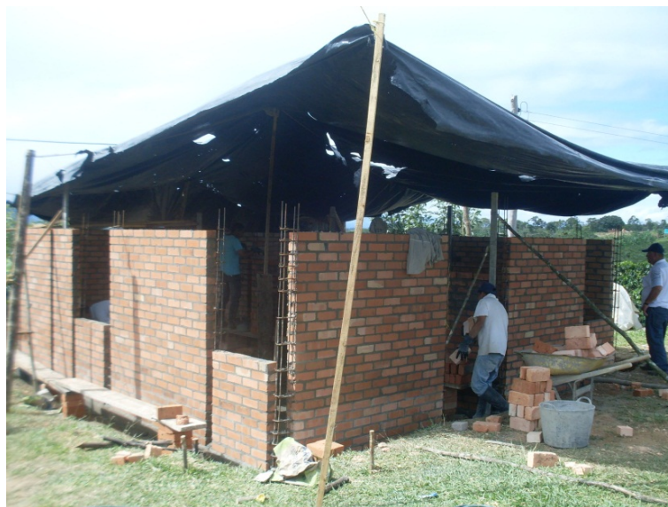
FIGURA 31. Foto mampostería confinada. Jose Wilson JojoaJojoa. Beneficiario El Danubio - Morales. Fuente: Archivo Rafael Carvajal
