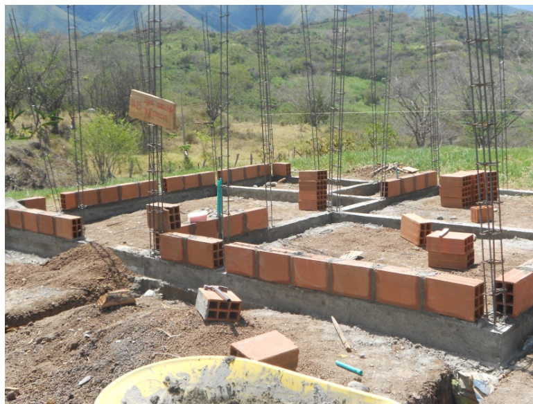
FIGURA 27. Foto de viga de cimentación terminada. Luis Carlos Valencia Lemus. Beneficiario La Balsa – Municipio de Páez. Fuente: Archivo Rafael Carvajal
