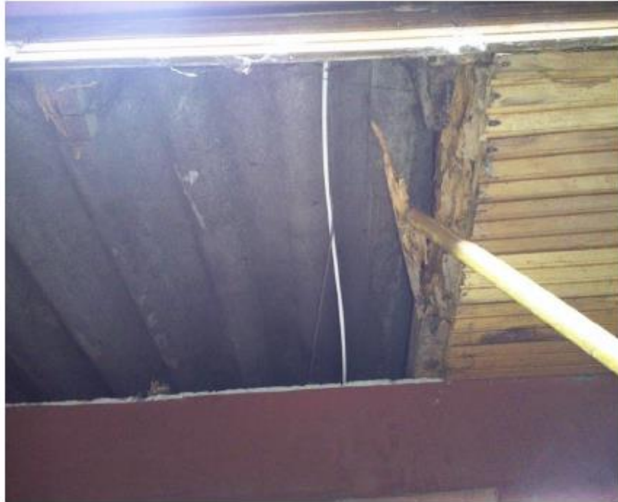
MADERA DE CUBIERTA DESTRUIDA POR LA POLILLA
