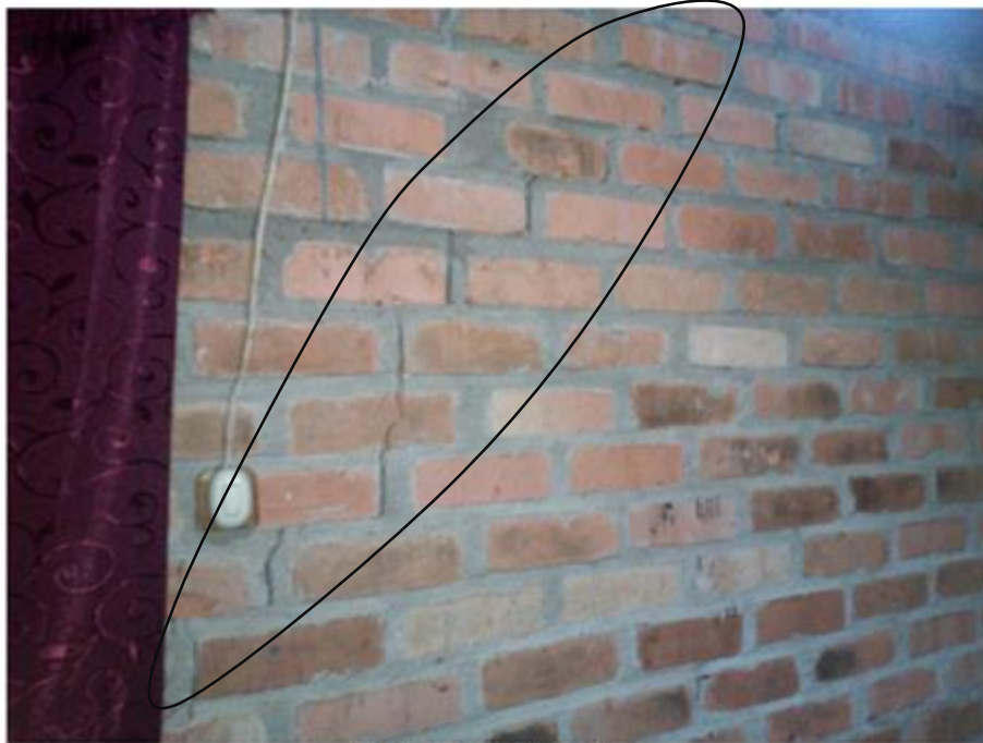
Grietas dentro de la casa
