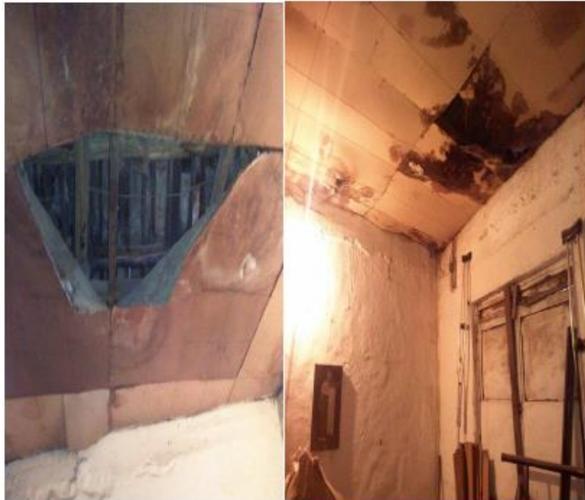
DE ESTRUCTURA DE CIELO RASO DAÑADO POR EL AGUA
