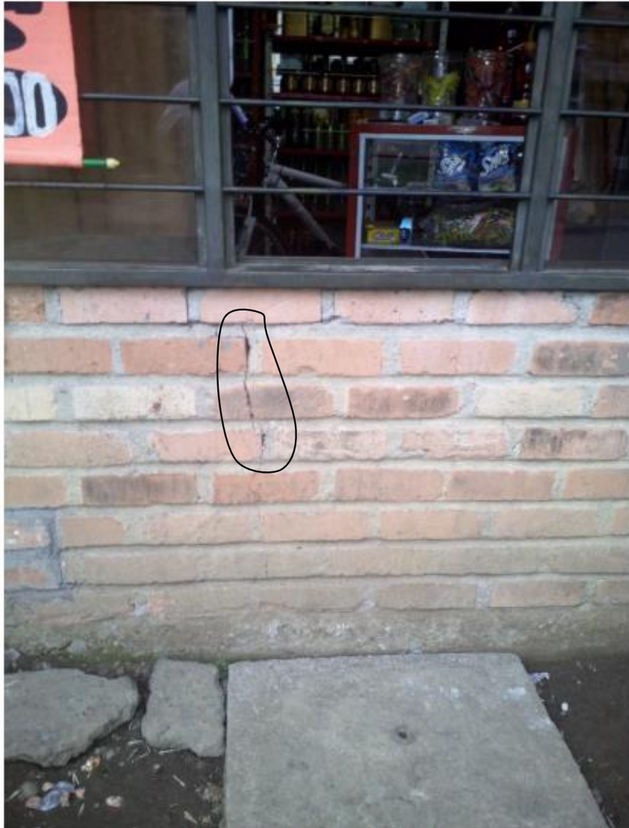
Grietas en la entrada de la vivienda
