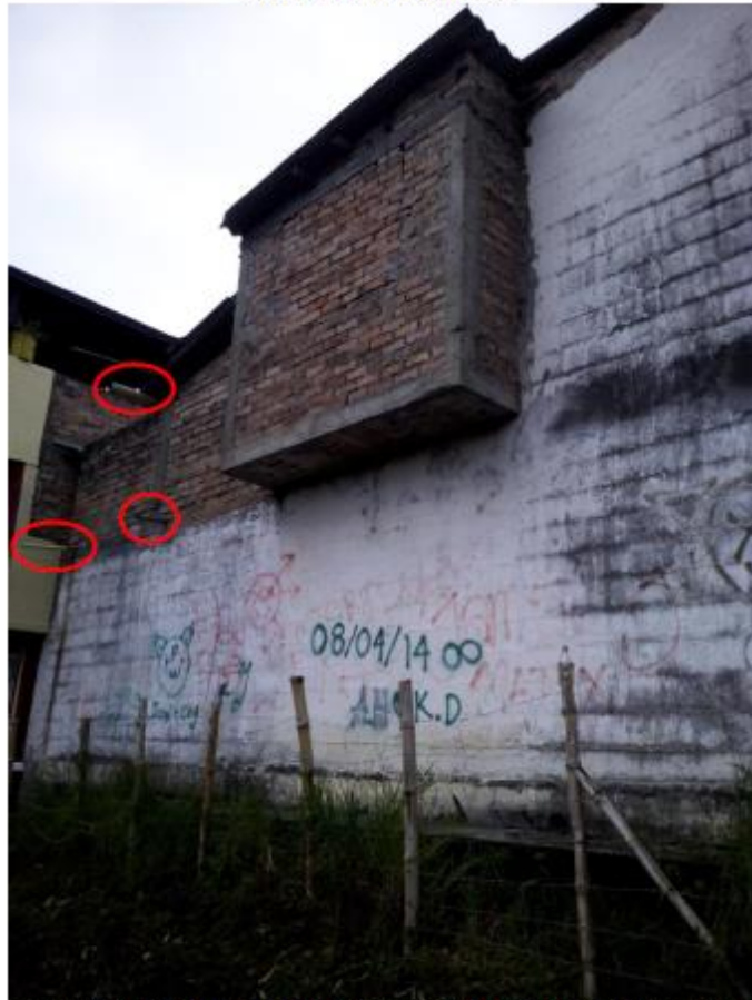
Parte posterior de la casa, detalle cerca, agua cayendo sobre el talud
