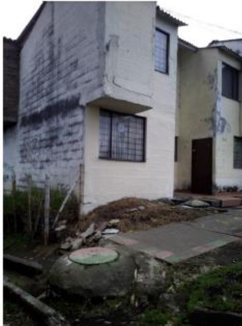
Detalle del pozo de inspección que puede estar ocasionando problemas.
