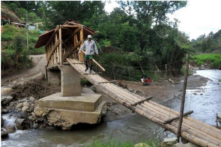
Ilustración 4. Puente de guadua en pueblillo alto destruido por creciente, Diciembre de 2013.
