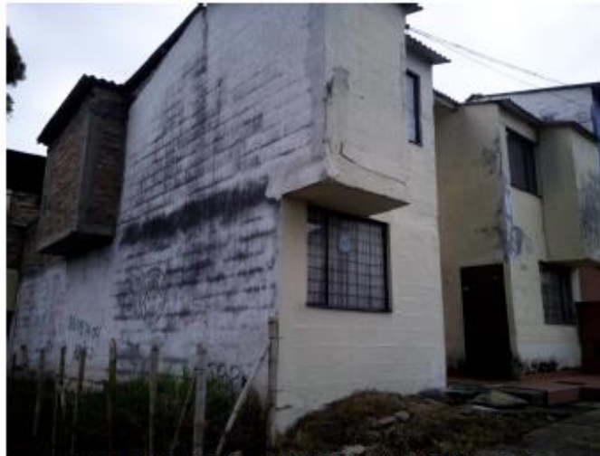
Detalle vivienda sin canales ni bajantes de aguas lluvia
