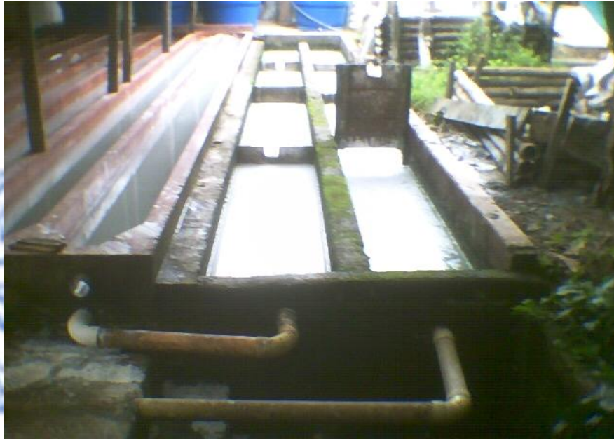
Fotografía J.7. Canal de sedimentación de mancha.
